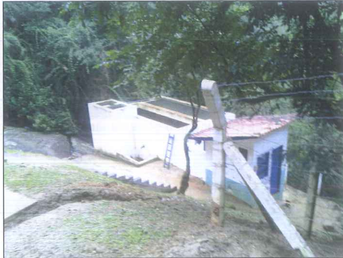
Figura 20: Casa de química da ETA não possui grade em uma das janelas e porta não possuía chave
