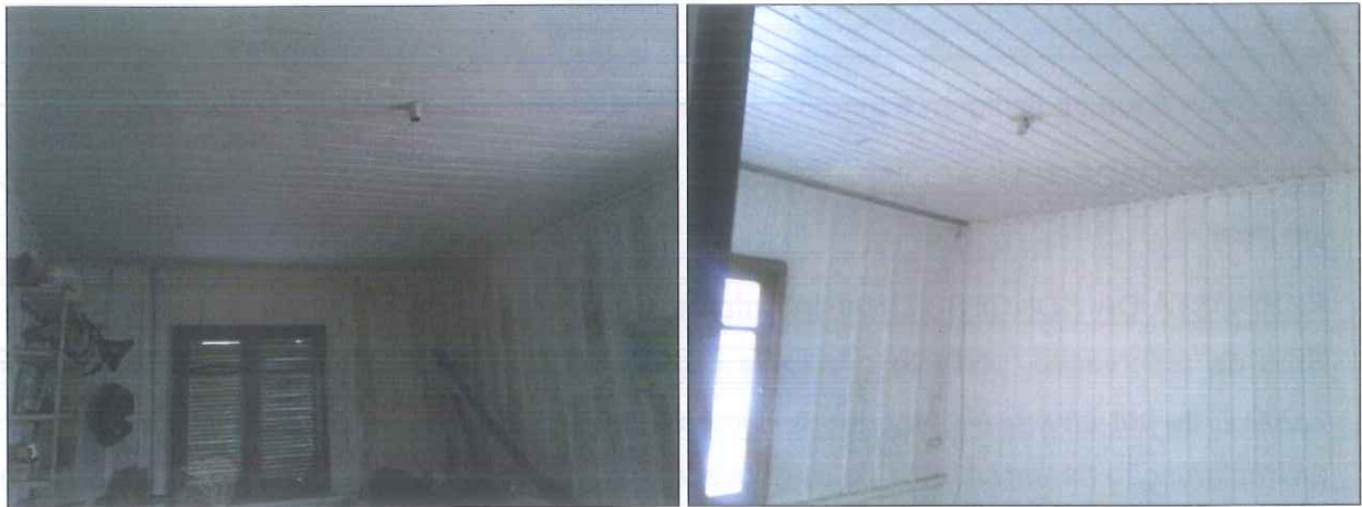
Figura 11: Duas salas do escritório de atendimento não possuíam lâmpadas para iluminação
