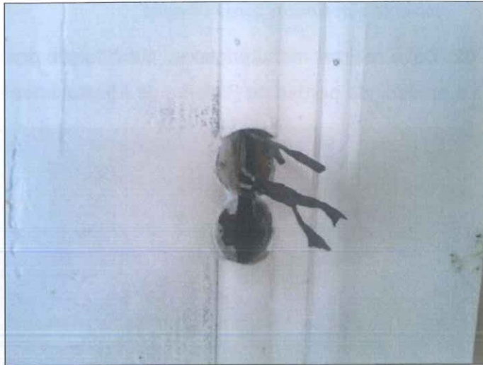
Figura 13: Circuitos elétricos instalados sem proteção física adequada, colocando em risco a estrutura física local
