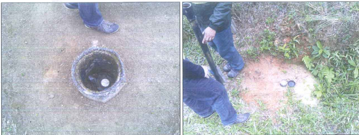
Figura 9: Macromedidores de entrada e saída do reservatório
