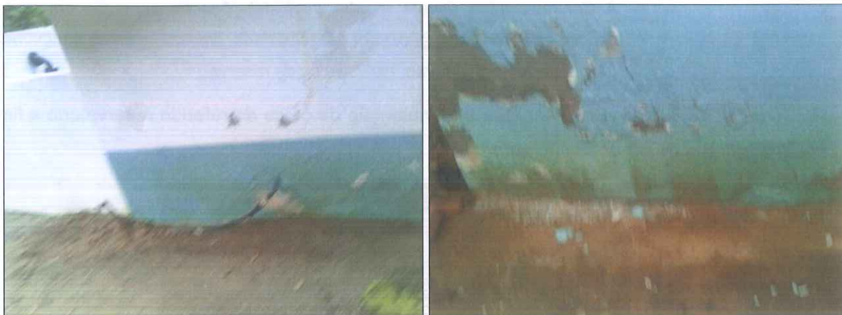
Figura 19: Problemas de infiltração nas paredes da casa de química
