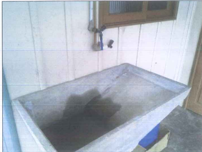
Figura 12: Vazamento em torneira no escritório de atendimento
