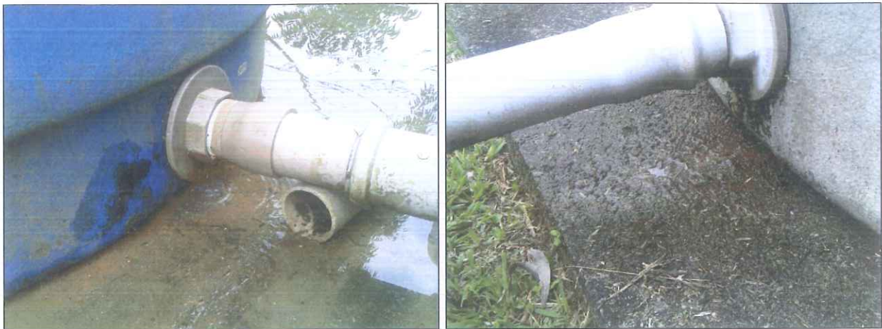
Figura 22: Vazamento nos reservatórios de fibra de vidro
