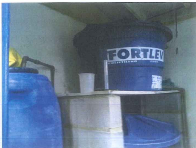
Figura 18: Casa de química não possuía lâmpada para iluminação
