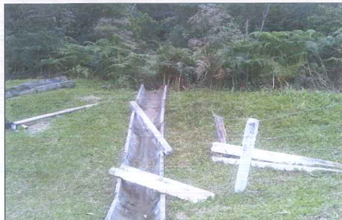
Figura 21: Cerca de proteção danificada no reservatório
