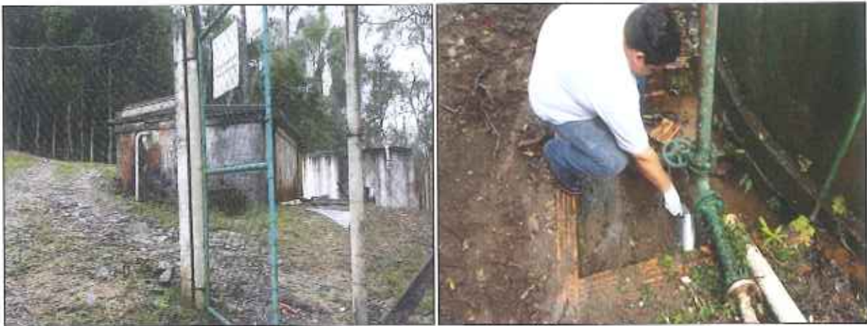
Figura 05: Coleta de amostra de água tratada próximo ao Reservatório R04
