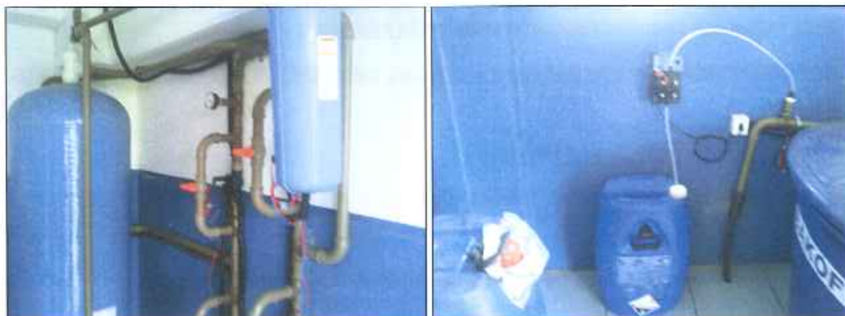
Figura 33: Unidades de tratamento da ETA V
