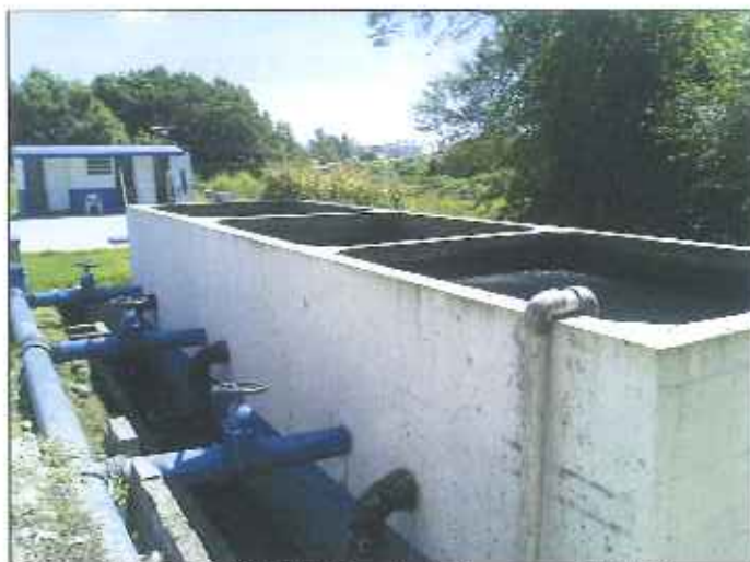
Figura 23: Unidades de tratamento ETA III
