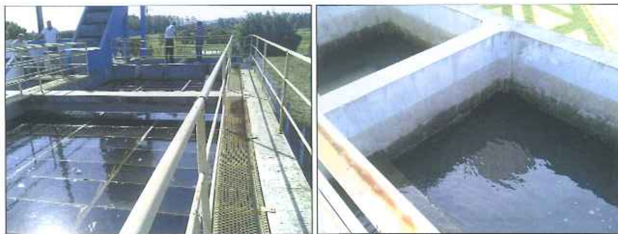
Figura 31: Unidades de tratamento da ETA IV
