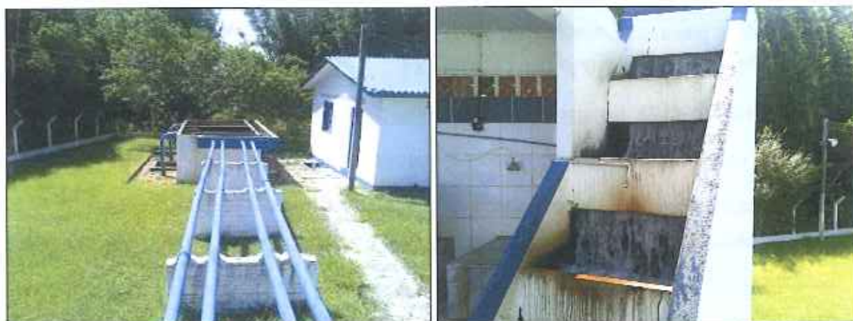
Figura 13: Unidades de tratamento da ETA I
