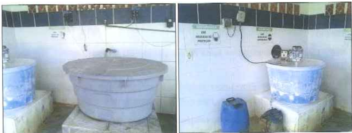
Figura 16: Casa de química da ETA I
