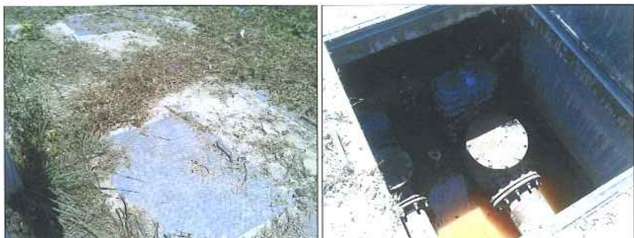
Figura 53: Estação Elevatória de Esgoto
