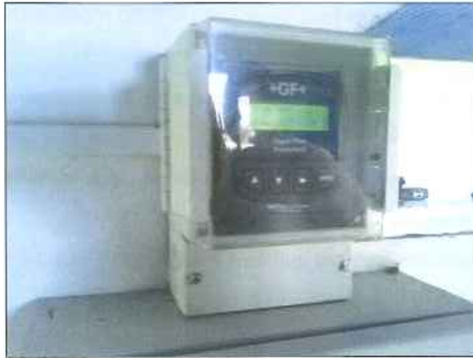
Figura 20: Macromedidor de vazão de saída
