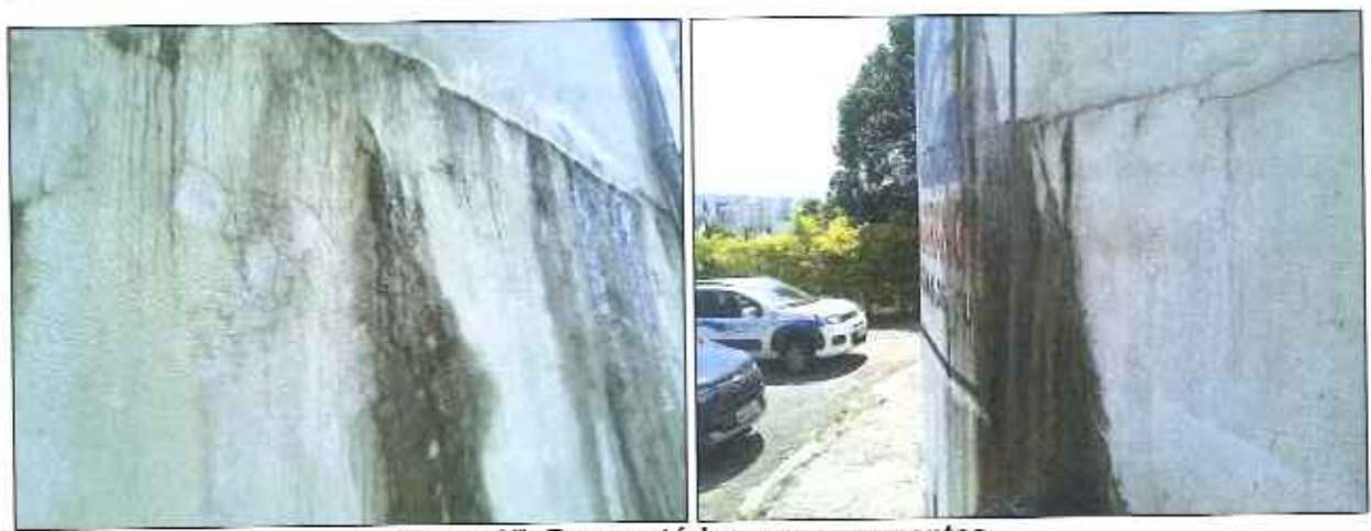
Figura 37: Reservatórios com vazamentos
