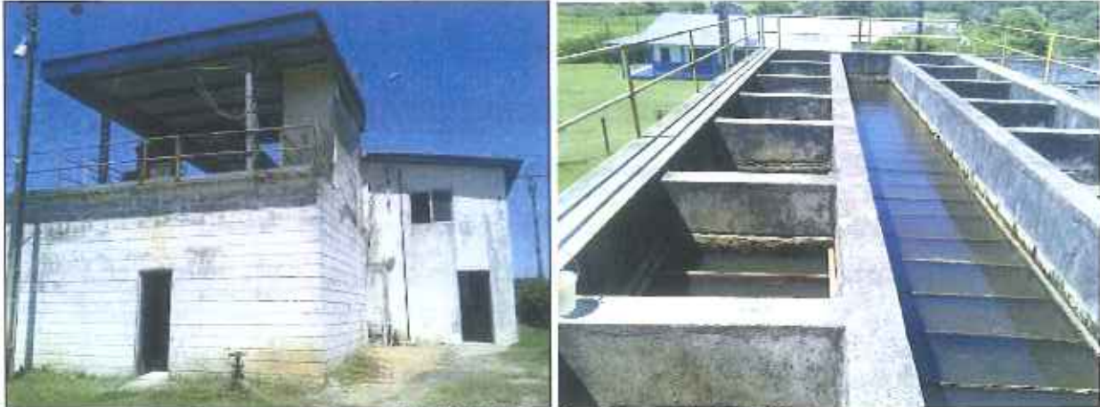
Figura 17: Unidades de tratamento ETA II
