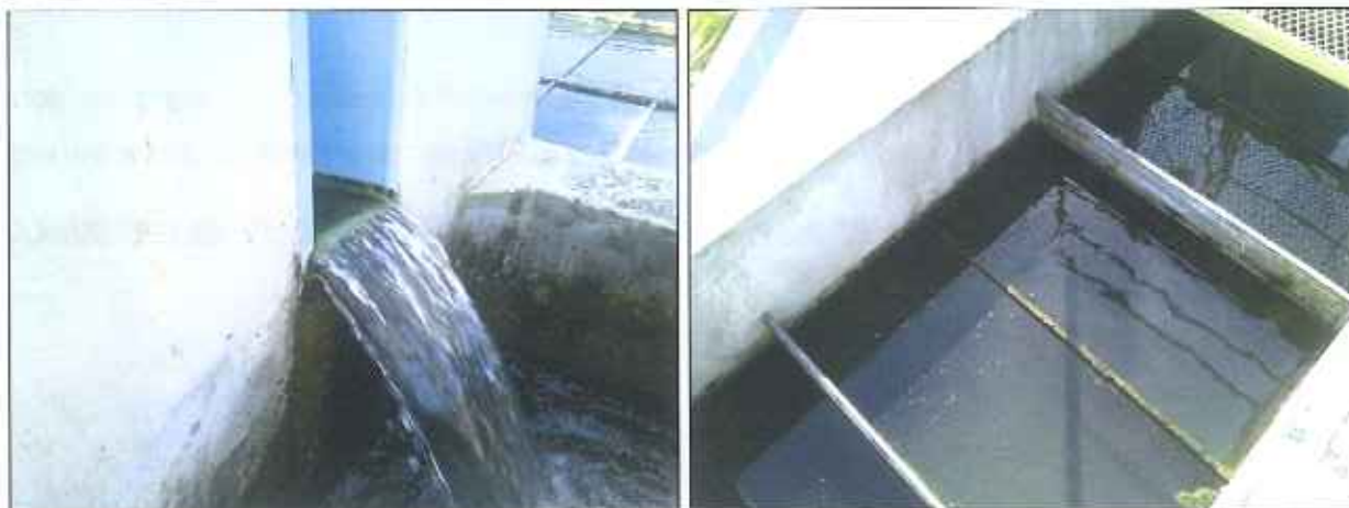
Figura 30: Unidades de tratamento da ETA IV
