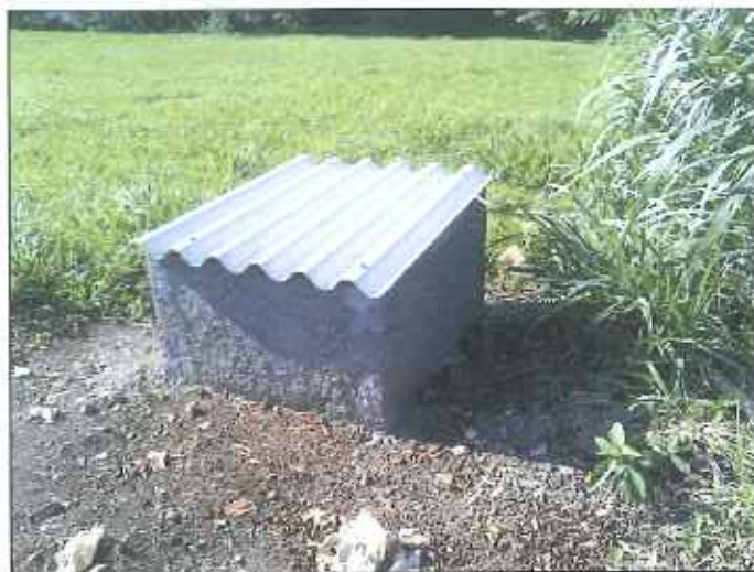
Figura 12: Poço Espigão da Pedra
