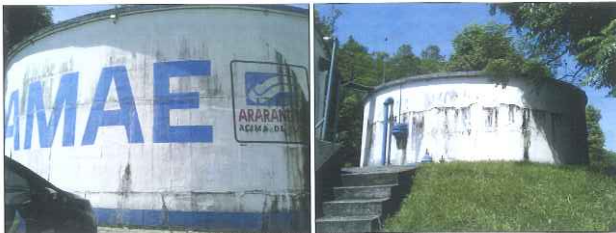
Figura 34: Reservatórios R01 e R02 interligados
