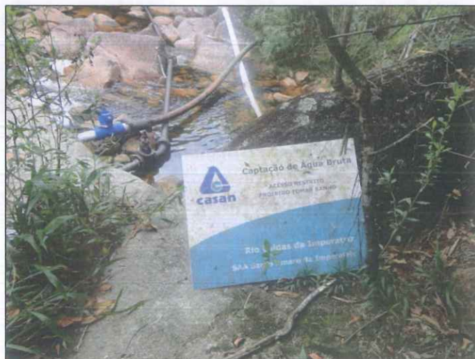
Figura 8: Placa de identificação em local inadequado
