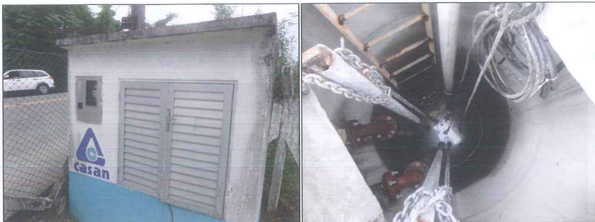
Figura 37: EEE B04 – casa de comando e poço úmido
