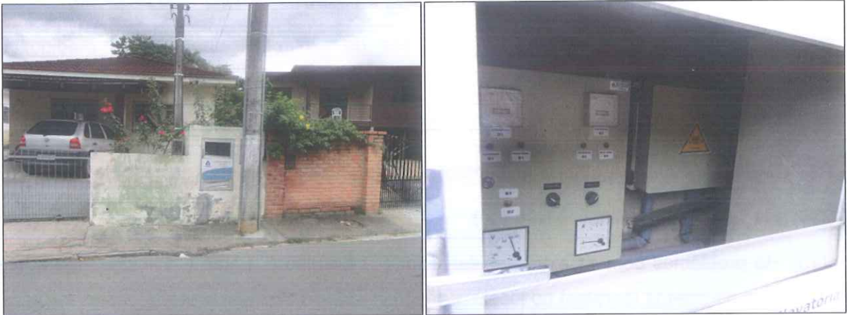
Figura 34: EEE B05 – Vista externa e interna do quadro de comando
