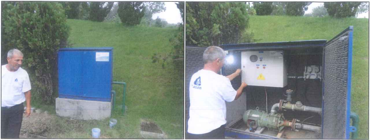
Figura 22: Vista externa e interna do Booster Pagará
