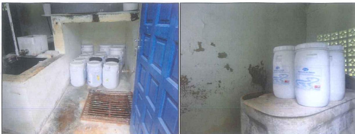
Figura 13: Armazenamento inadequado dos produtos químicos
