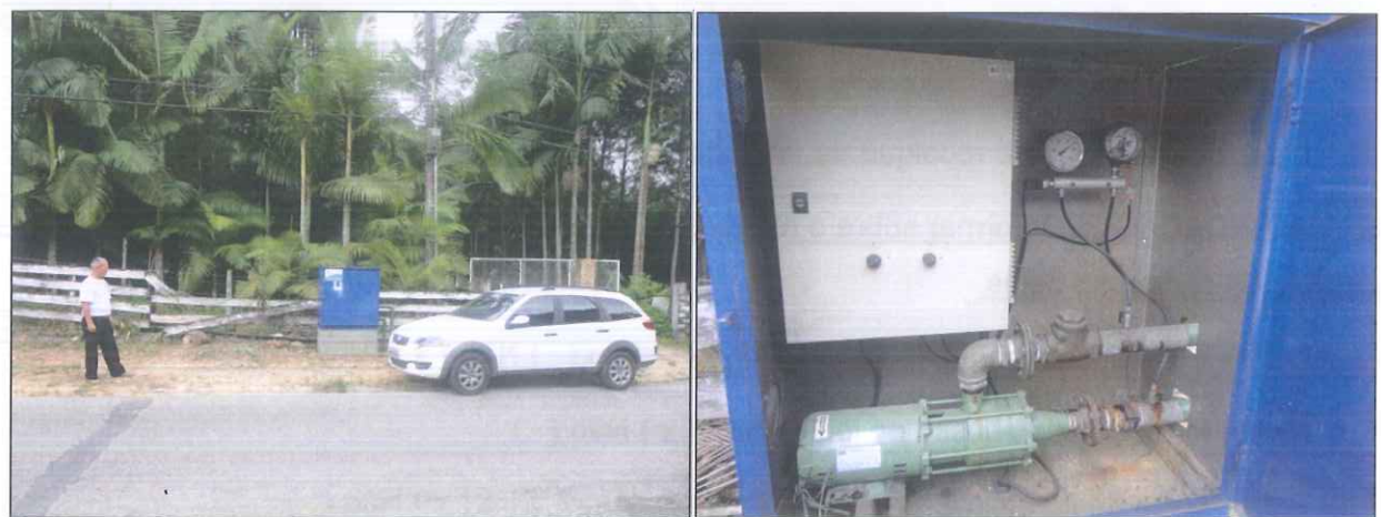
Figura 17: Vista externa e interna do Booster Três Voltas
