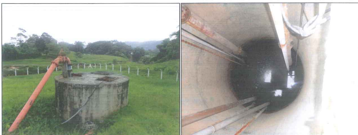
Figura 41: EEE B02 – Vista externa e interna do poço úmido
