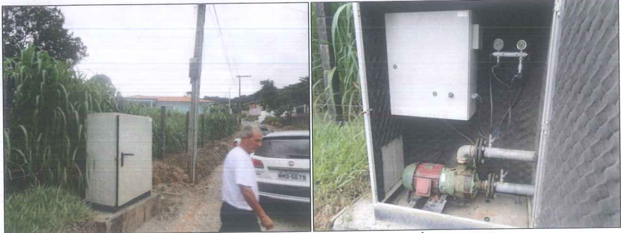
Figura 19: Vista externa e interna do Booster Águias Delta
