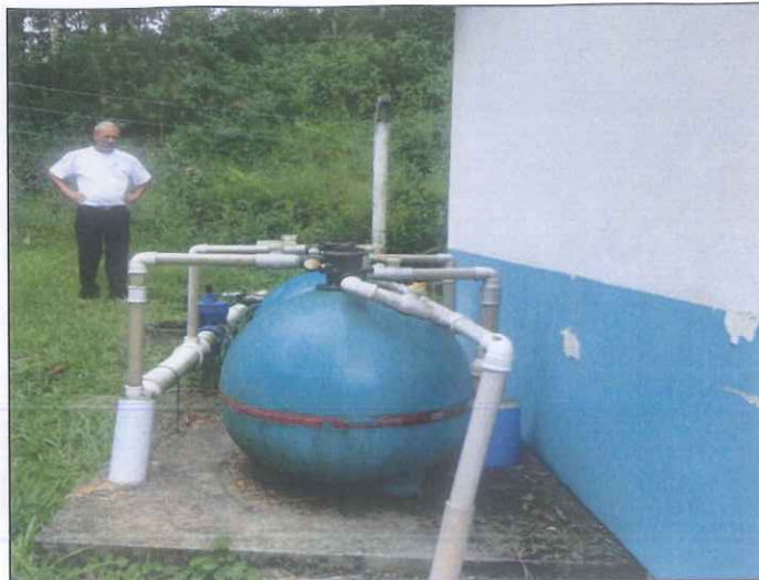
Figura 11: Filtros de areia
