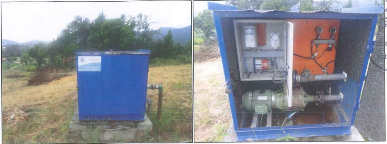
Figura 21: Vista externa e interna do Booster Nossa S. Dores
