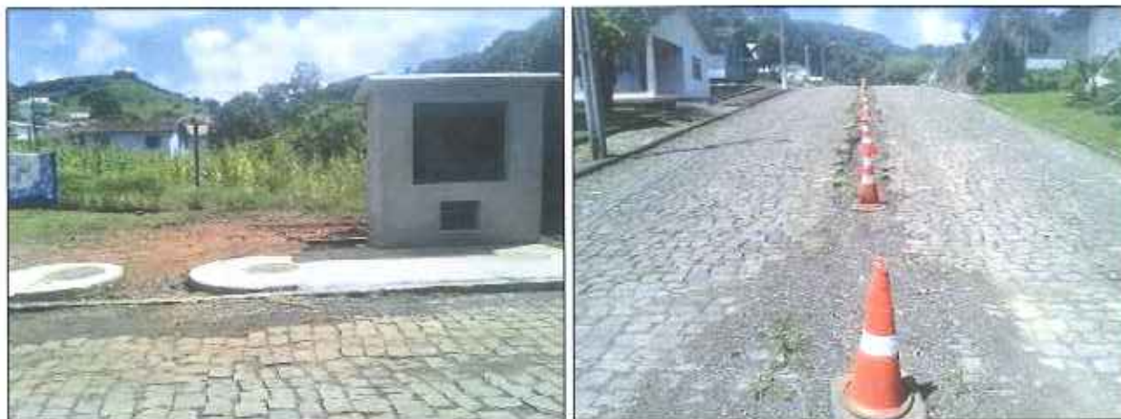
Figura 13: Estação Elevatória de Esgoto
