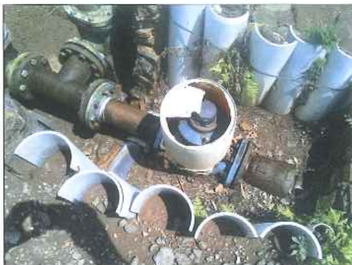
Figura 14: Macro medidor de vazão no Reservatório R02 inoperante
