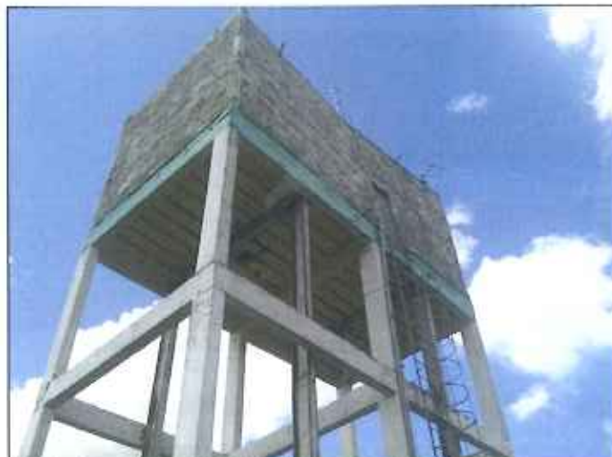
Figura 15: Reservatório R03 com estrutura física comprometida
