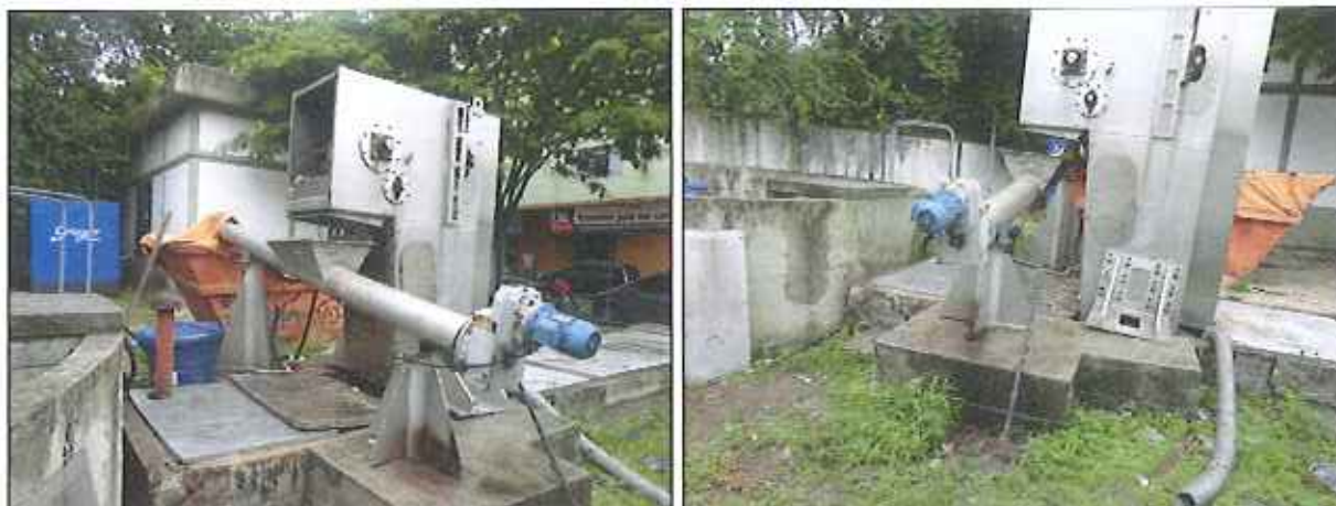
Figura 2: Gradeamento mecanizado e contêiner instalado na EEE de Campinas
