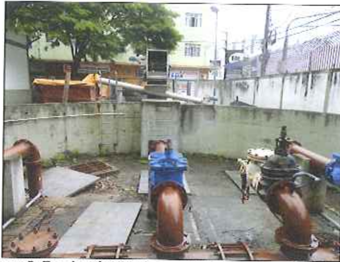
Figura 5: Bombas instaladas na EEE Campinas (28/01/2016)
