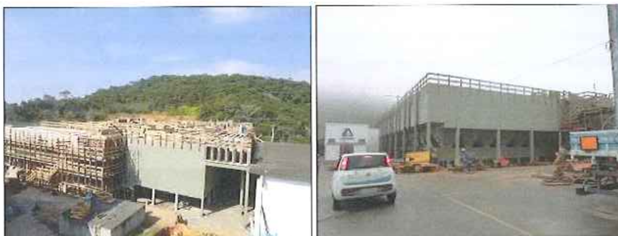
Figura 3: Situação das obras de ampliação da ETA nos meses de Outubro (à esquerda) e Dezembro (à direita) de 2015
