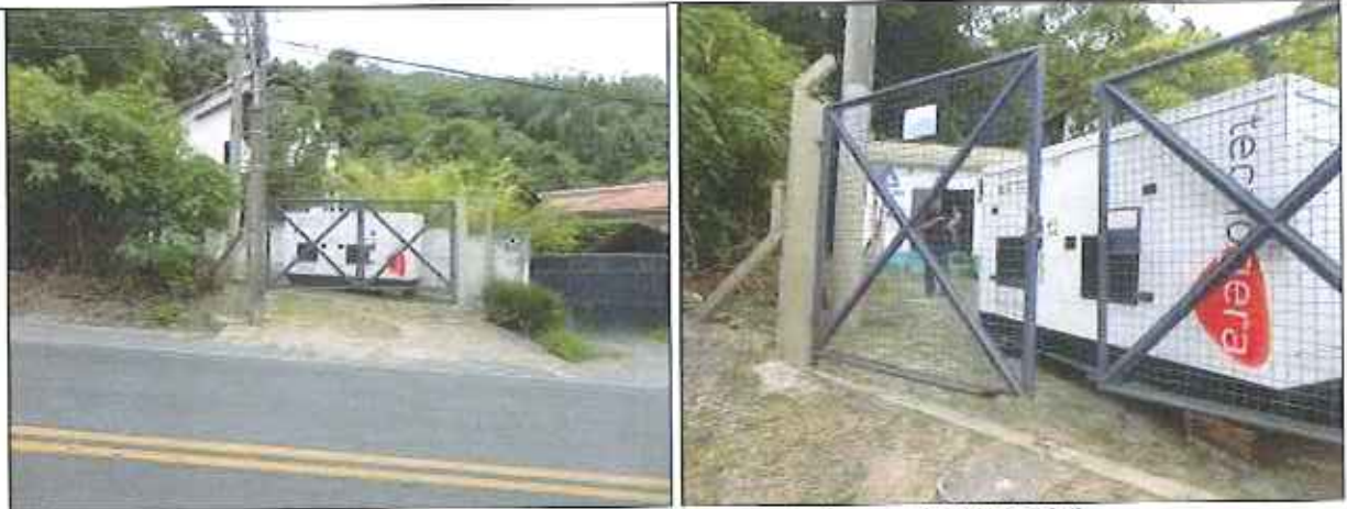
Figura 34: Gerador no Booster Barra da Lagoa (17/12/2015)
