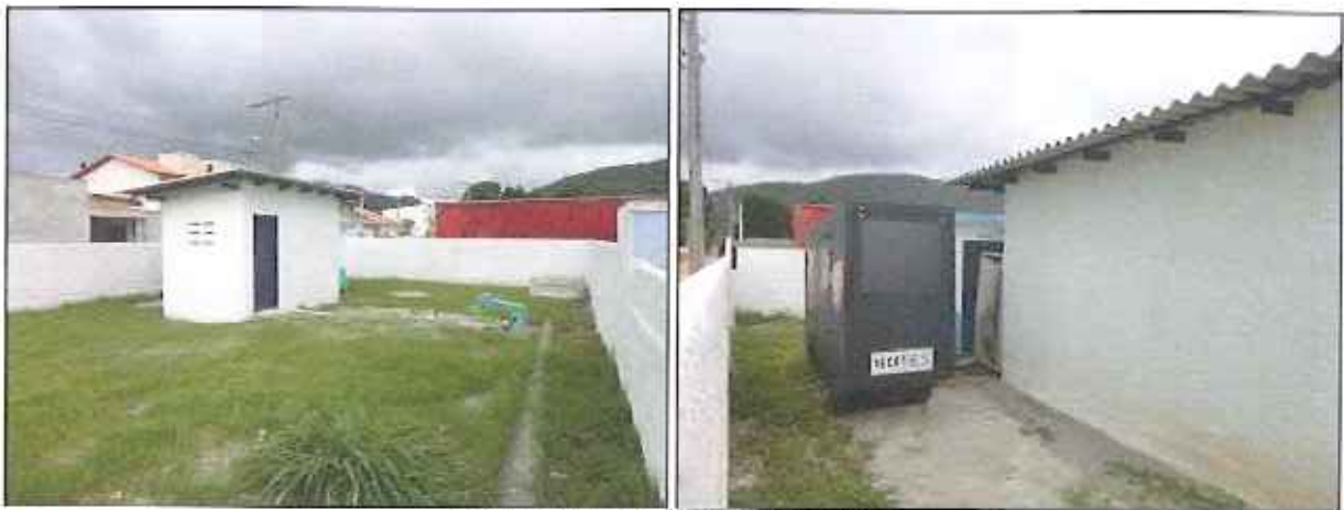
Figura 24: Gerador no Poço Ciro
