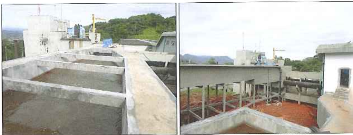
Figura 7: Canais de entrada e saída do floccodecantador da ETA (06/01/2016)
