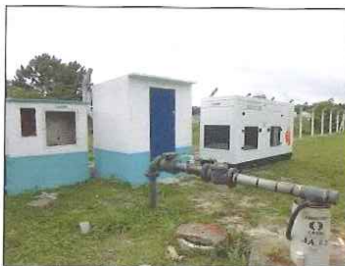
Figura 27: Gerador no Poço Emundo III
