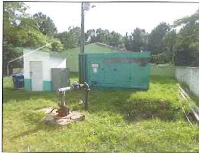
Figura 23: Gerador no Poço Dunas Verdes
