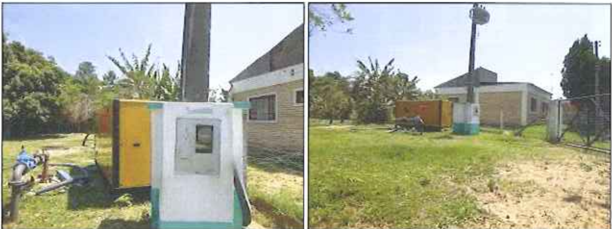
Figura 15: Gerador no Poço Palmeiras
