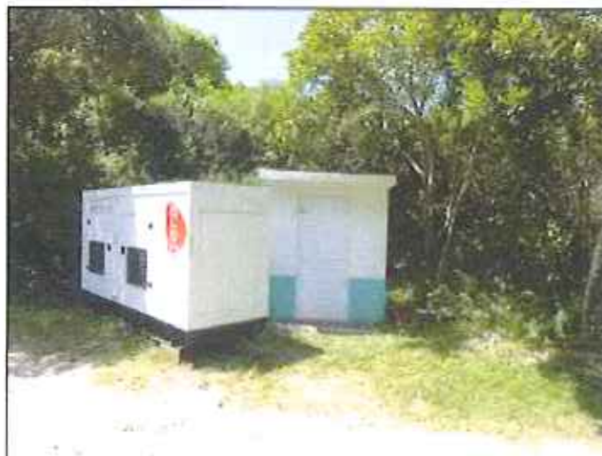
Figura 16: Gerador no Poço Costão Golf
