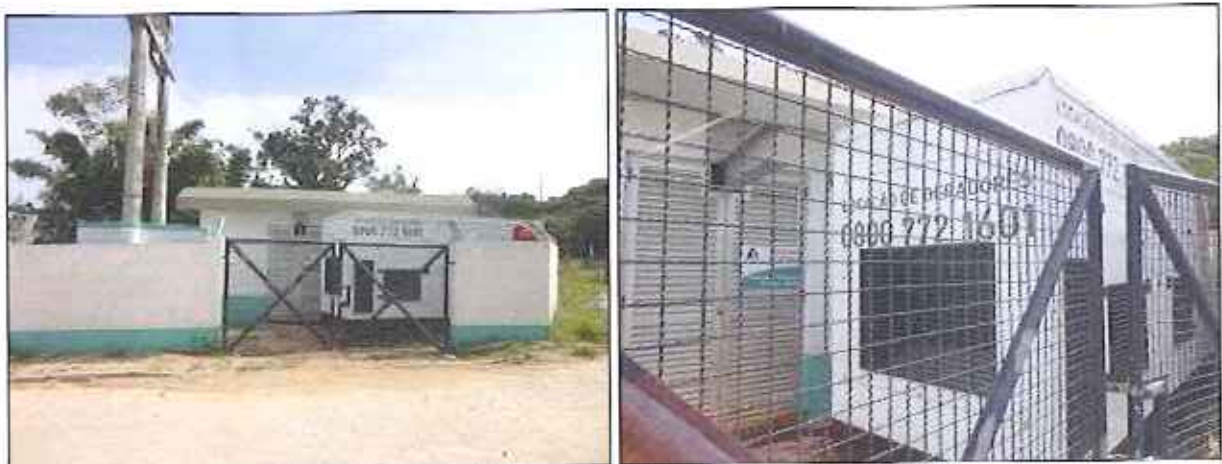
Figura 31: Gerador no Booster Três Marias (16/12/2015)
