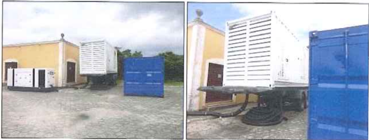
Figura 32: Geradores na ETA Lagoa do Peri (17/12/2015)
