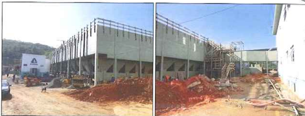
Figura 4: Situação das obras de ampliação da ETA no momento da vistoria do Plano de Emergência (16/12/2015)
