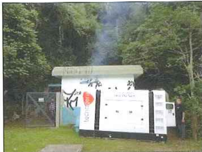
Figura 35: Gerador no Booster Canto da Lagoa (17/12/2015)
