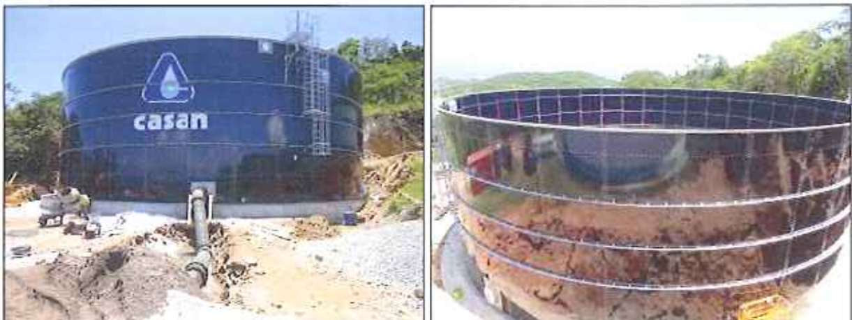
Figura 13: Situação das obras do novo reservatório dos Ingleses no momento da vistoria do Plano de Emergência (16/12/2015)
