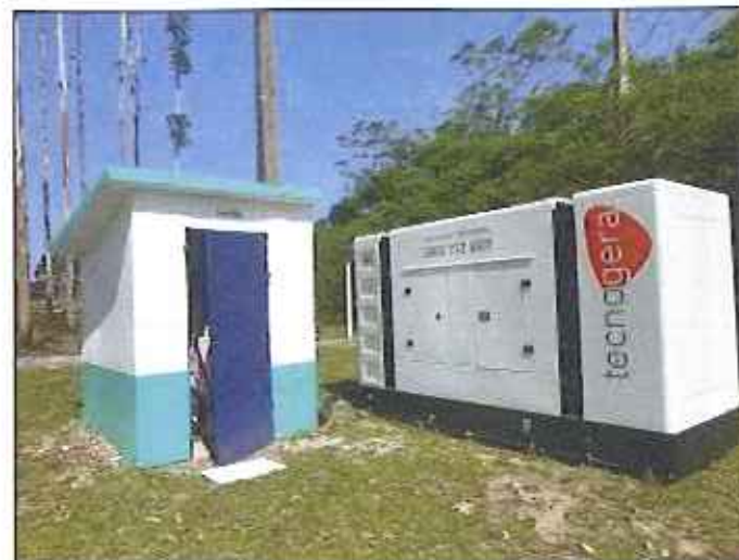
Figura 22: Gerador no Poço Paulinho da Matriz IV
