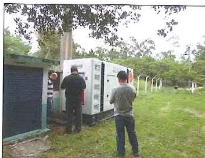
Figura 28: Gerador no Poço Areial
