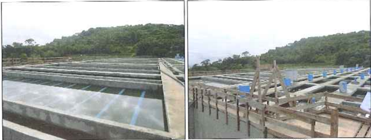
Figura 6: Floccodecantador da ETA em pré-operação (06/01/2016)
