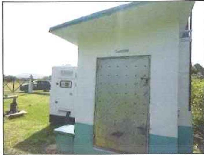
Figura 20: Gerador no Poço Paulinho da Matriz II
