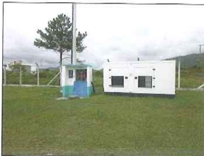
Figura 26: Gerador no Poço Edmundo III
