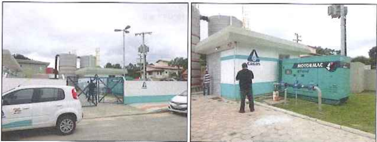
Figura 33: Gerador na ETA Campeche (17/12/2015)
