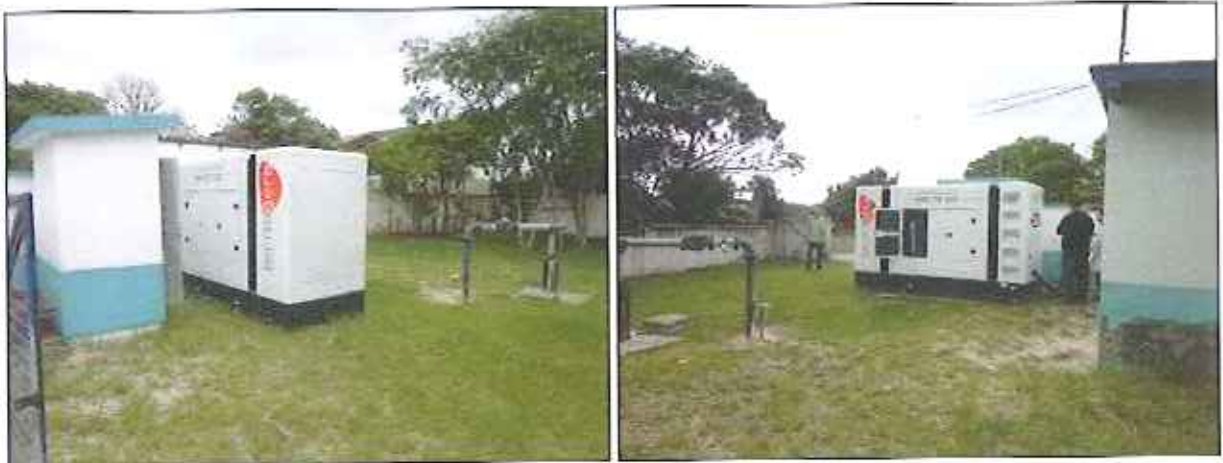
Figura 30: Gerador no Poço Moçambique
