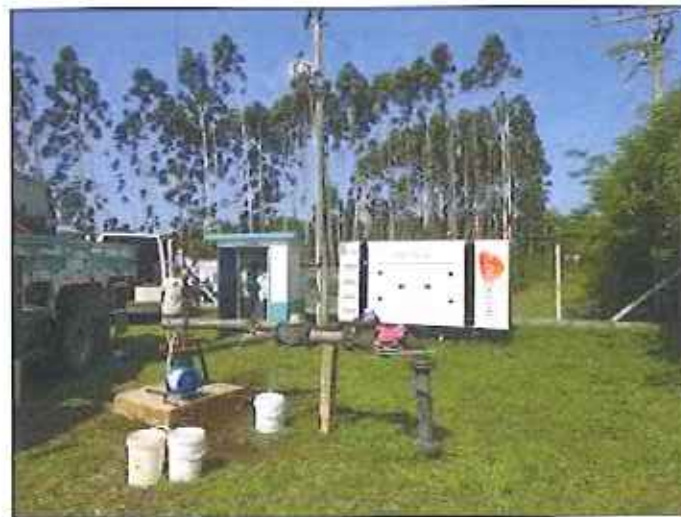
Figura 21: Gerador no Poço Paulinho da Matriz III
