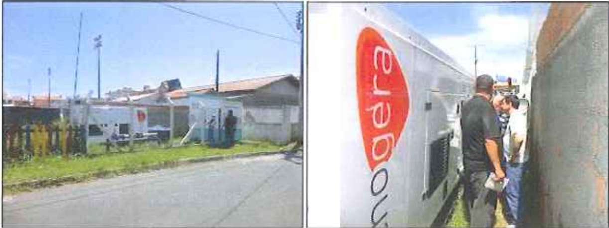
Figura 14: Gerador no Poço Santinho
