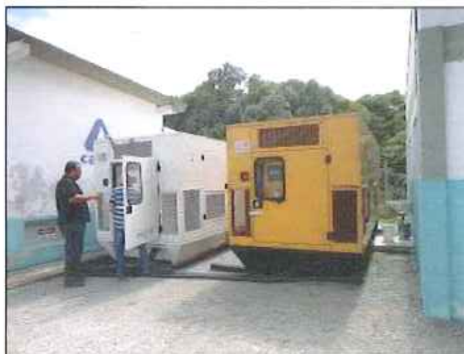
Figura 9: Geradores ETA Ingleses (16/12/2015)
