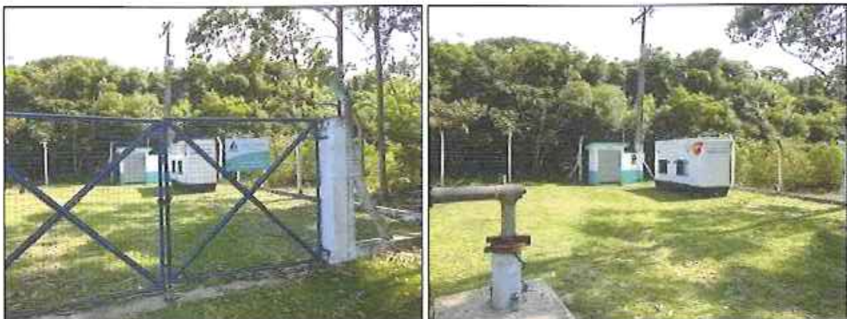
Figura 19: Gerador no Poço Paulinho da Matriz I
