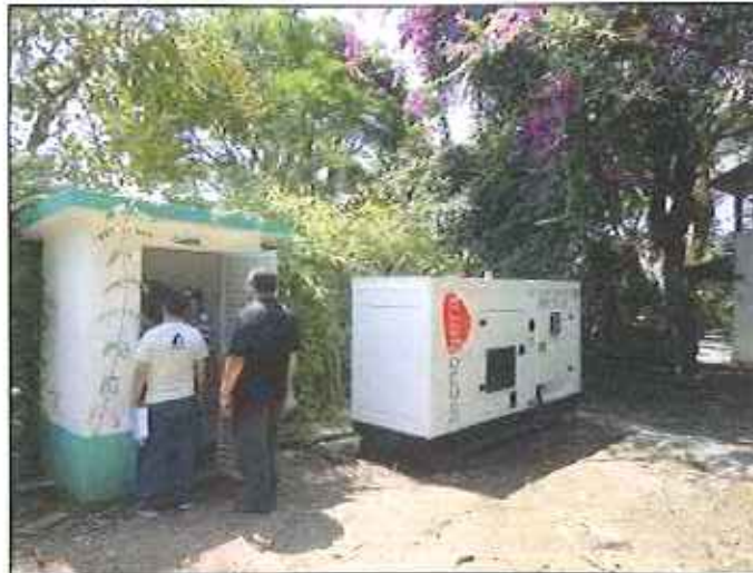
Figura 17: Gerador no Poço RBS
