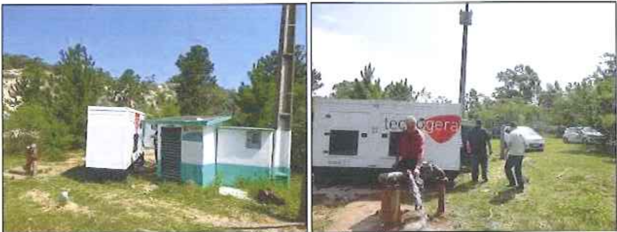
Figura 18: Gerador no Poço Bianco
