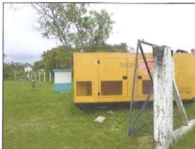
Figura 25: Gerador no Poço Edmundo I
