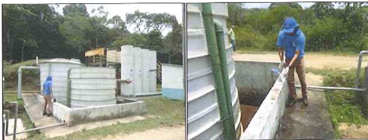
Figura 2: Coleta de amostra de água na ETA Compacta Lagoa da Conceição
