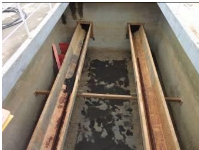
Figura 5: Filtro desativado temporariamente
