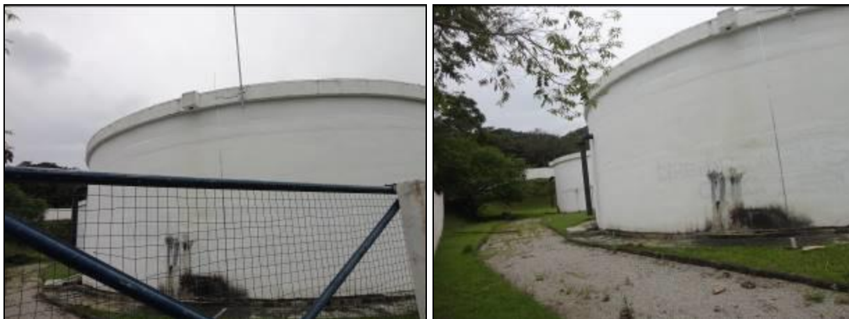
Figura 7: Reservatório 3 em operação
