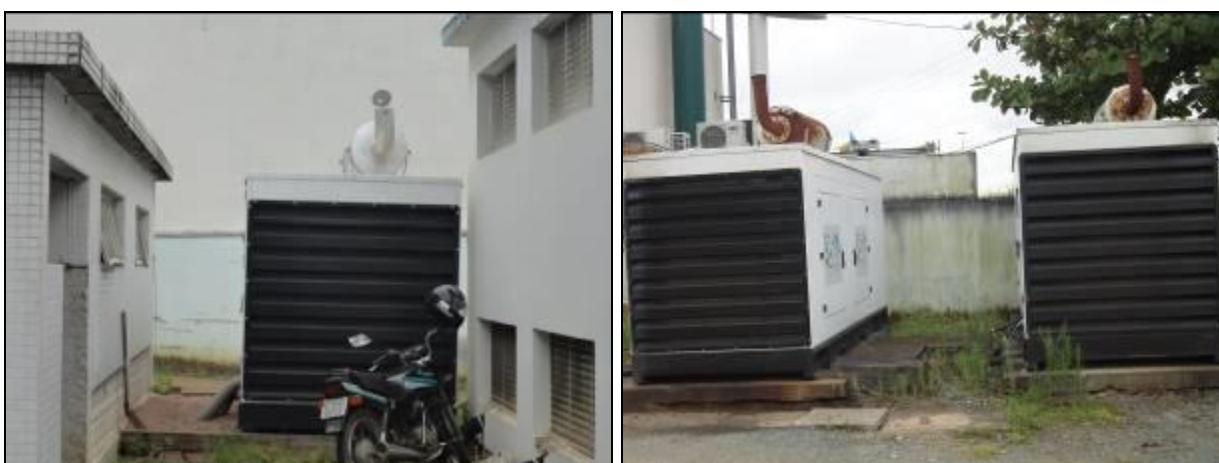
Figura 4: Grupos geradores de energia elétrica da ETA
