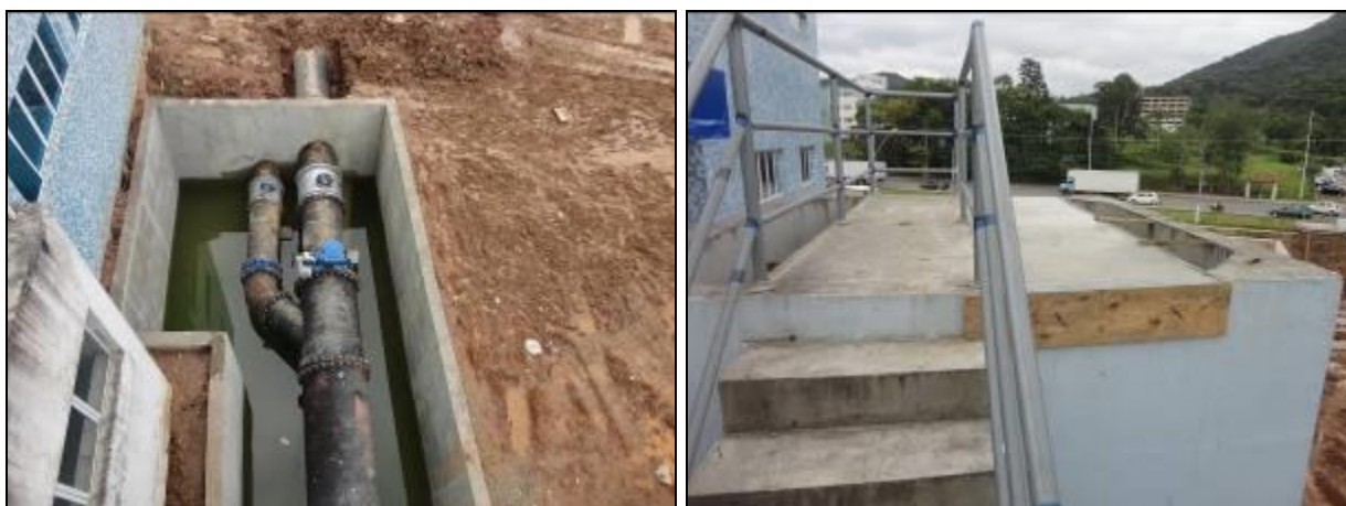
Figura 2: Macromedidores instalados na adutora de 800 mm (à esquerda) e nova caixa de passagem para dosagem de produtos químicos (à direita)
