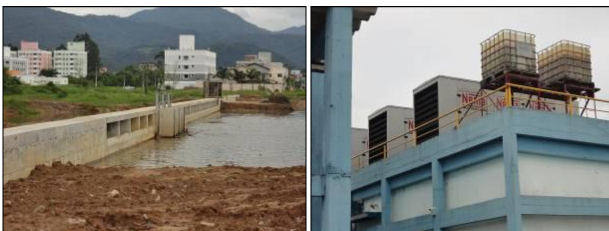
Figura 6: Captação de água bruta do Rio Camboriú (à esquerda) e grupos geradores de energia elétrica da ERAB (à direita)
