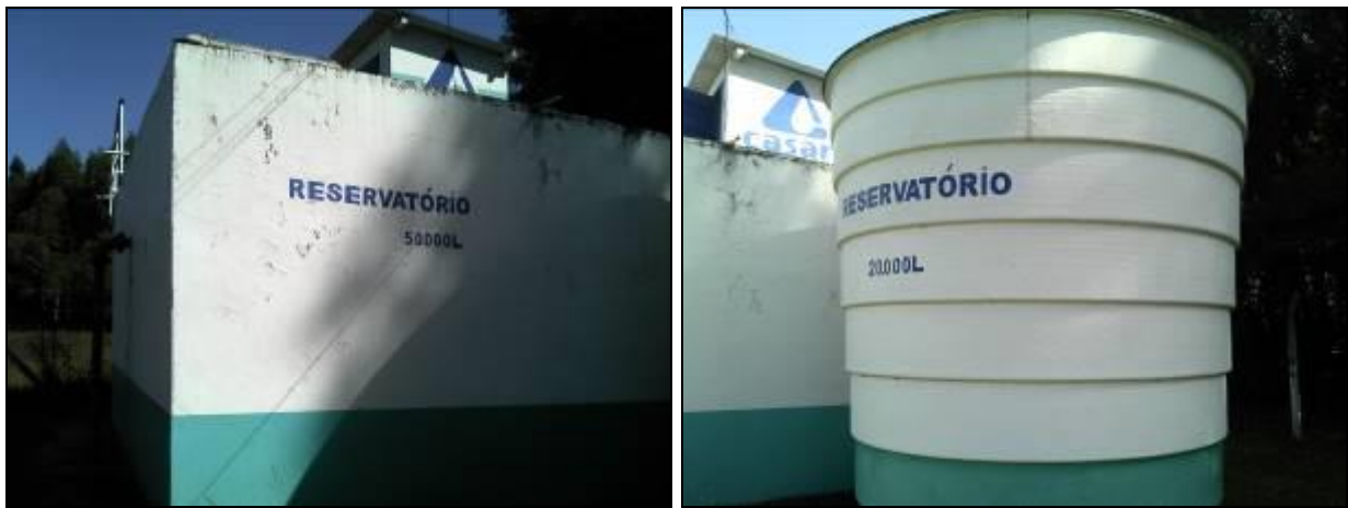
Figura 13: Tanque de contato e Reservatório
