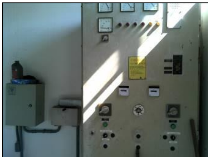
Figura 24: Quadro de comando da ERAB
