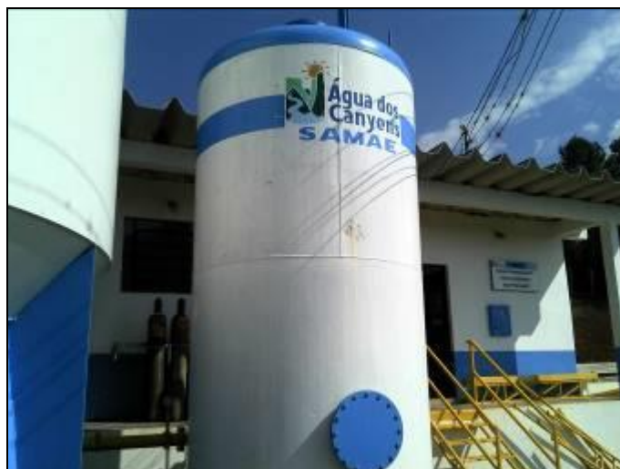
Figura 16: Filtro da ETA
