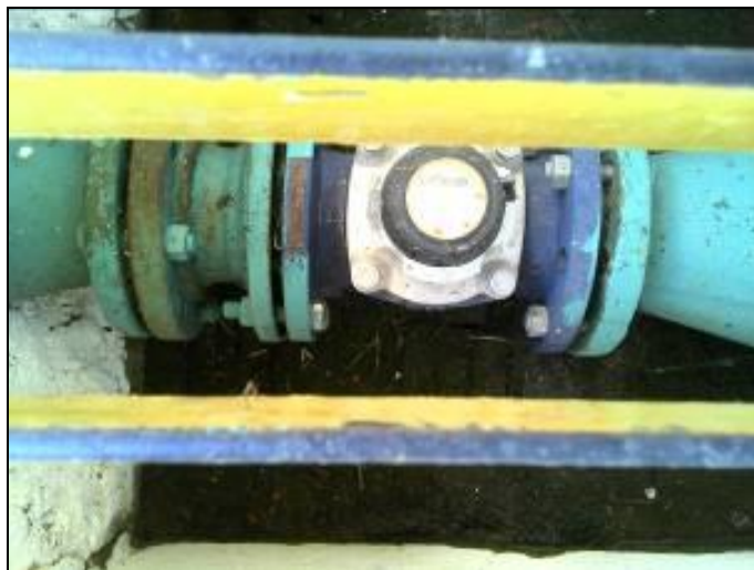
Figura 13: Macromedidor de saída
