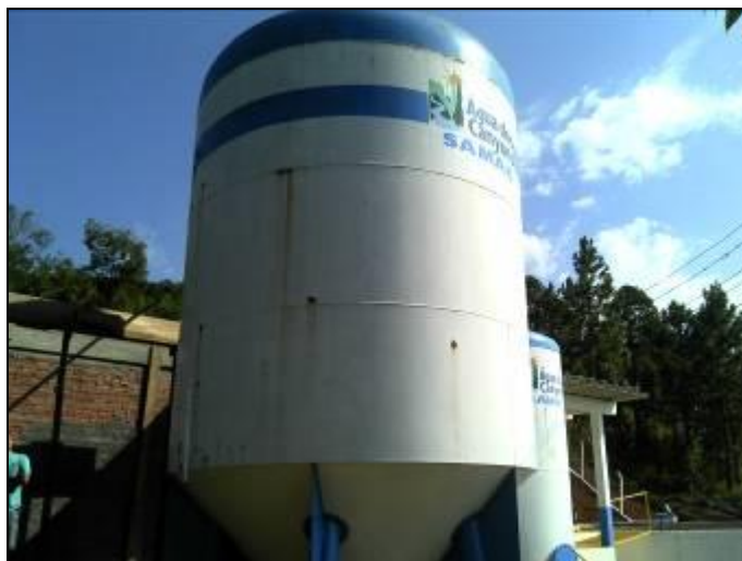
Figura 15: Floccodcantador da ETA
