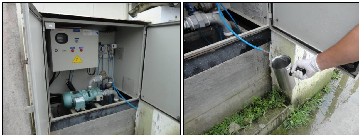
Figura 14: coleta de amostra de água no Booster Praia Brava III
