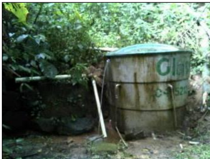
Figura 3: Captação de água bruta Boa Parada
