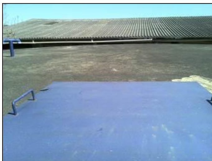
Figura 34: Área de Cobertura do Reservatório
