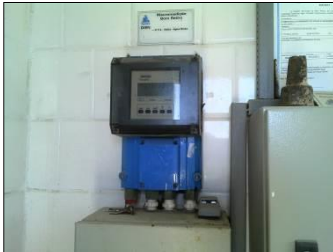
Figura 23: Macromedidor de entrada
