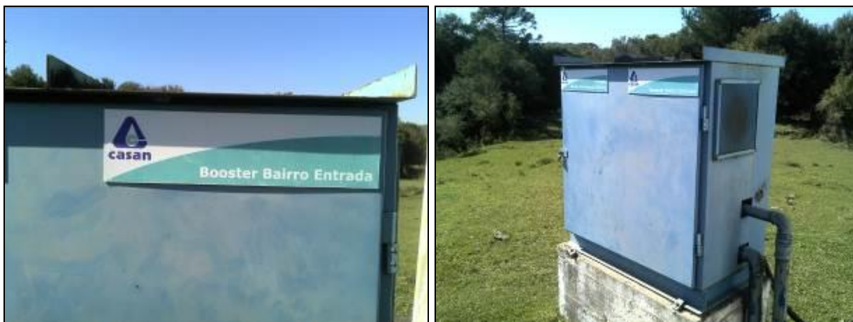
Figura 41: Boostes Bairro Entrada
