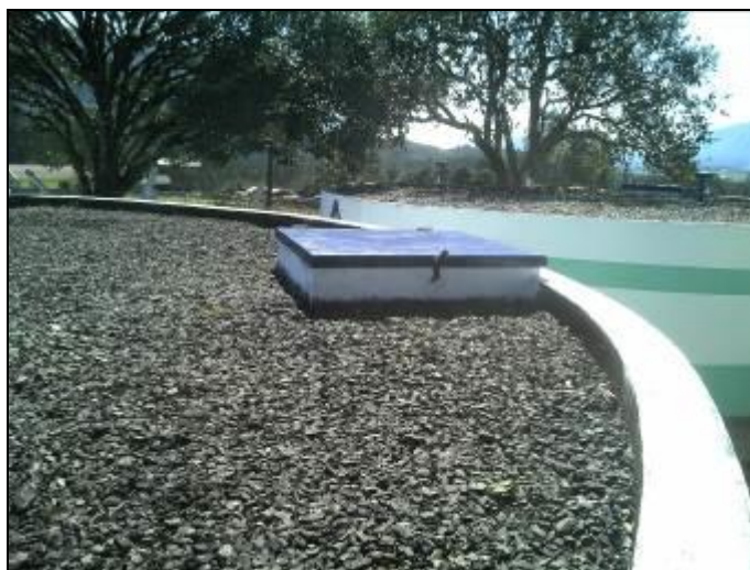
Figura 37: Área de cobertura do reservatório
