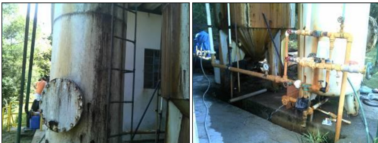
Figura 17: Péssimas condições da ETA
