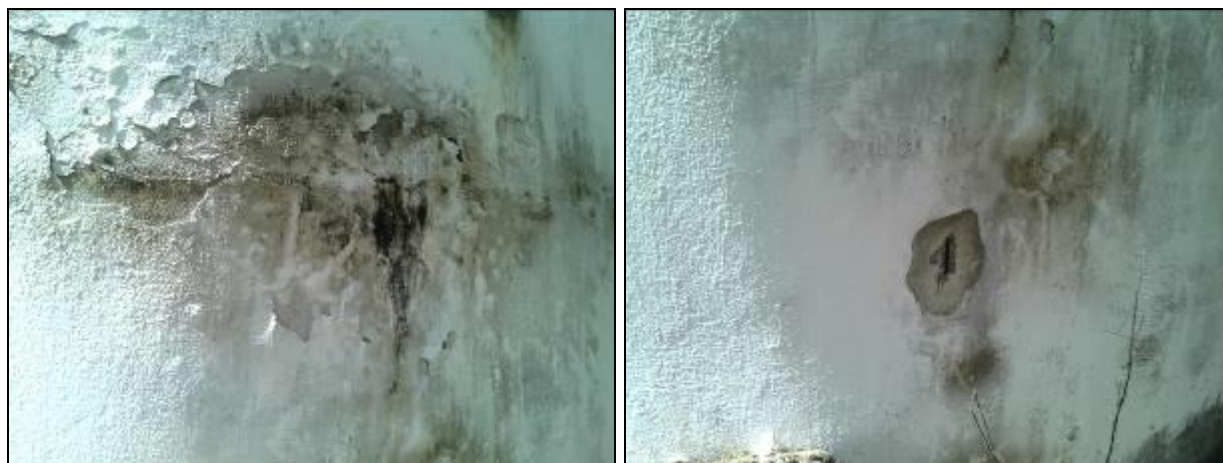
Figura 25: Fotos do Reservatório com infiltrações.
