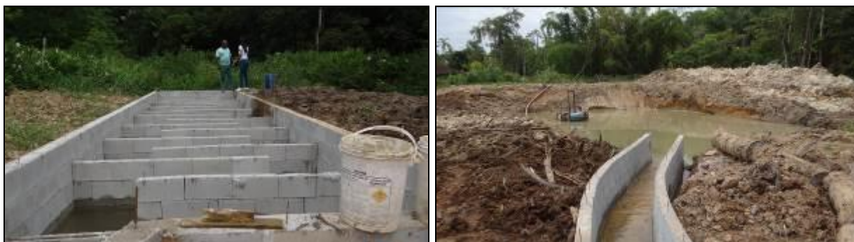
Figura 3: Unidades do tratamento da ETA Rua das Carpas
