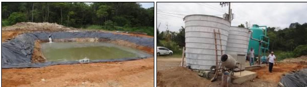
Figura 2: Unidades do tratamento da ETA Rua das Carpas
