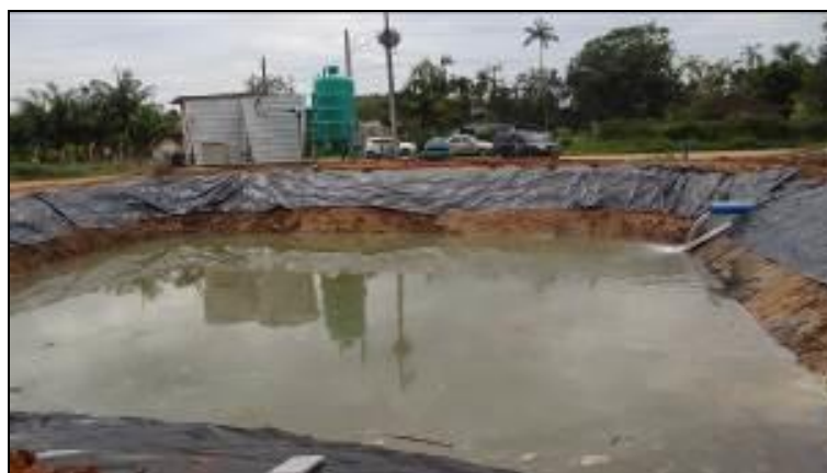
Figura 1: ETA Rua das Carpas
