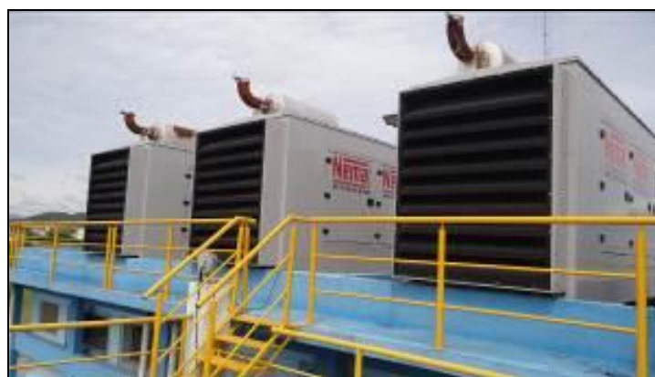
Figura 7: Grupos geradores de energia elétrica da captação
