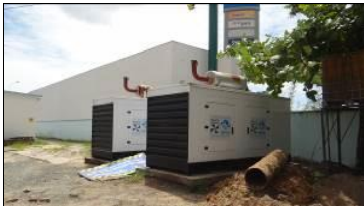
Figura 2: Grupos geradores de energia elétrica da ETA
