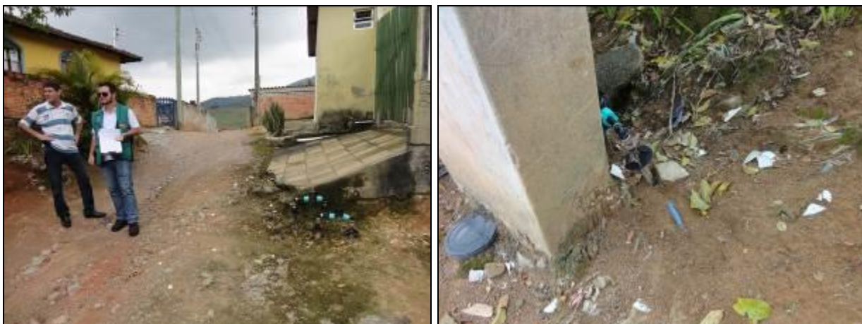
Figura 3: Servidão contemplada com melhorias de Rede de Distribuição e Hidrometração
