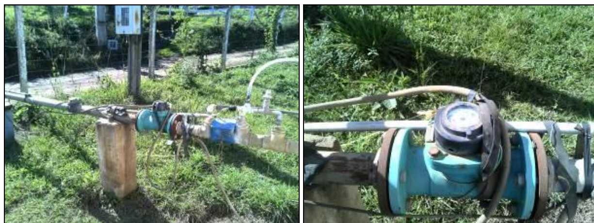
Figura 10: Poço 1 e macromedidor (acompanhamento)
