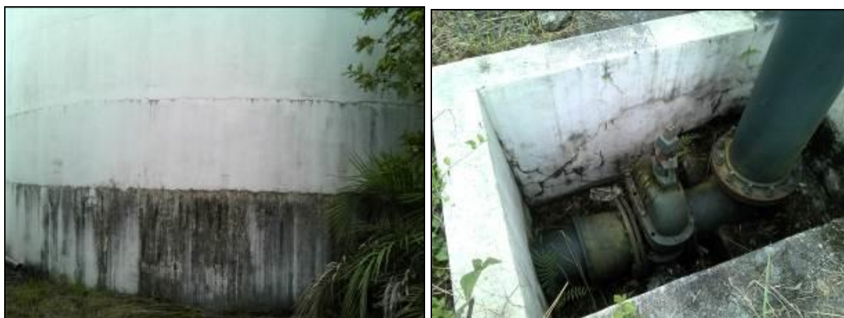
Figura 22: Reservatório Central com rachaduras e sem gradeamento (acompanhamento)
