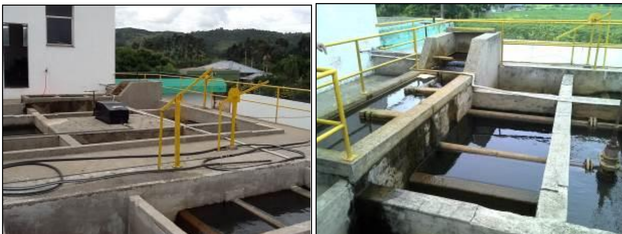
Figura 14: Floculadores, decantadores e filtros (inicial e acompanhamento)
