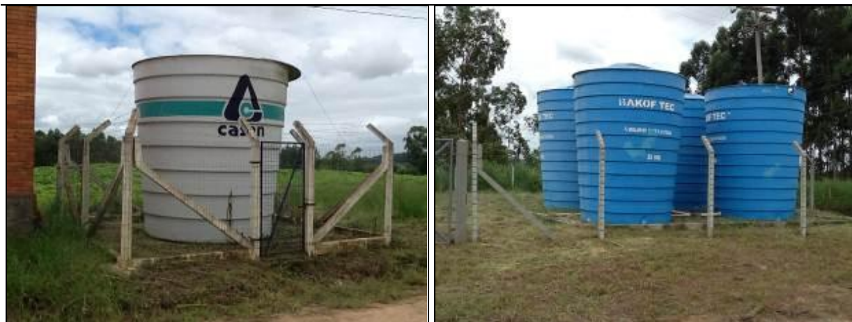
Figura 21: Outros reservatórios do sistema (inicial)
