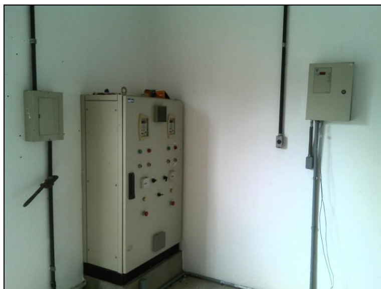
Figura 24: Quadro de Energia e Disjuntor
