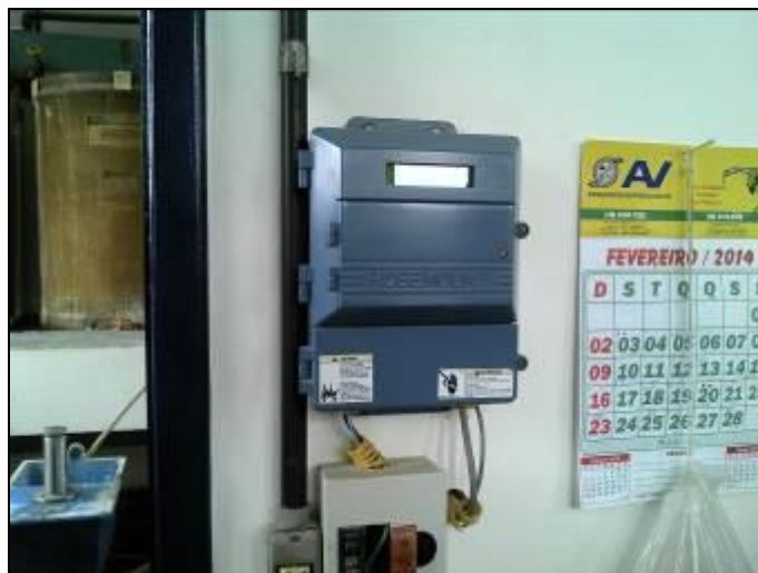
Figura 11: Macromedidor saída (acompanhamento)
