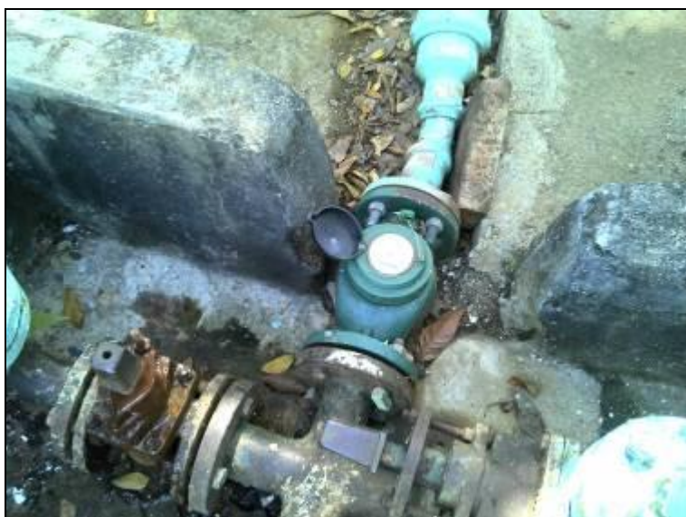
Figura 9: Macromedidor de Entrada
