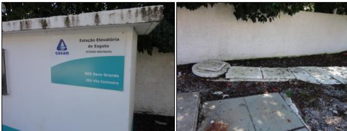
Figura 3: EEE sem o vazamento no terreno (06/03/2014)
