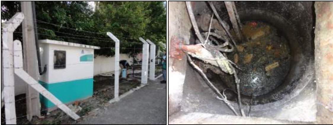
Figura 1: Estação Elevatória de Esgoto Vila Cachoeira (19/02/2014)
