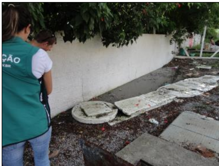
Figura 2: Vazamento de esgoto bruto no próprio terreno da EEE (19/02/2014)
