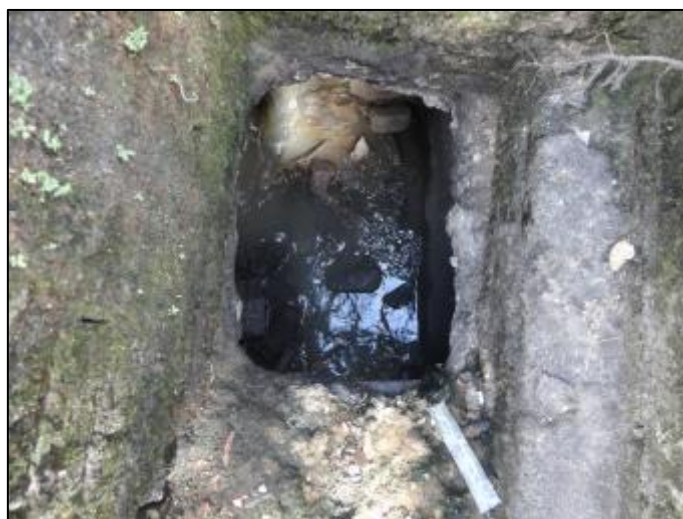
Figura 2: Lançamento do efluente bruto na rede pluvial (19/02/2014)
