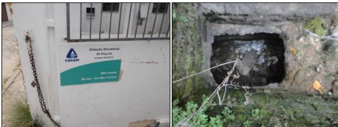
Figura 3: Lançamento do esgoto bruto (06/03/2014)
