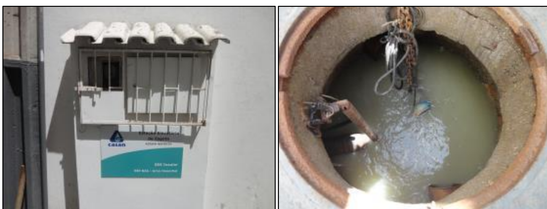
Figura 1: Estação Elevatória de Esgoto inoperante (19/02/2014)
