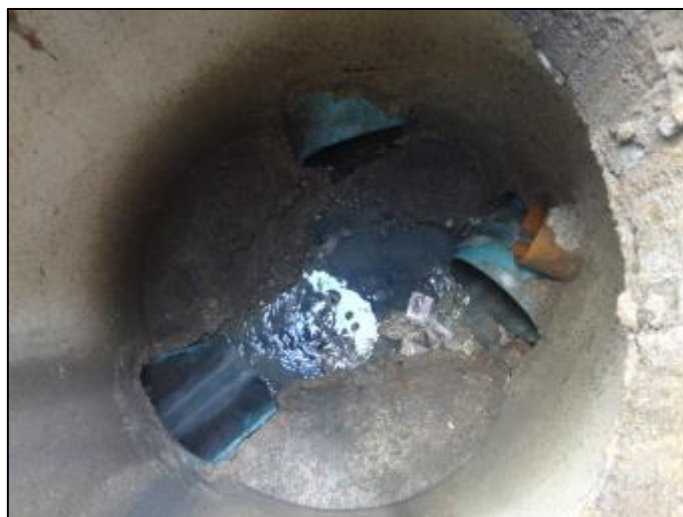
Figura 2: Lançamento de efluente bruto na rede pluvial (19/02/2014)
