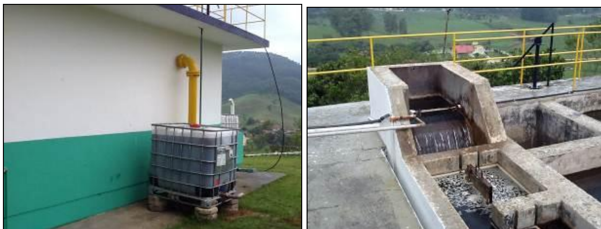
Figura 18: Produto químico adicional (E) e entrada da água bruta (D)
