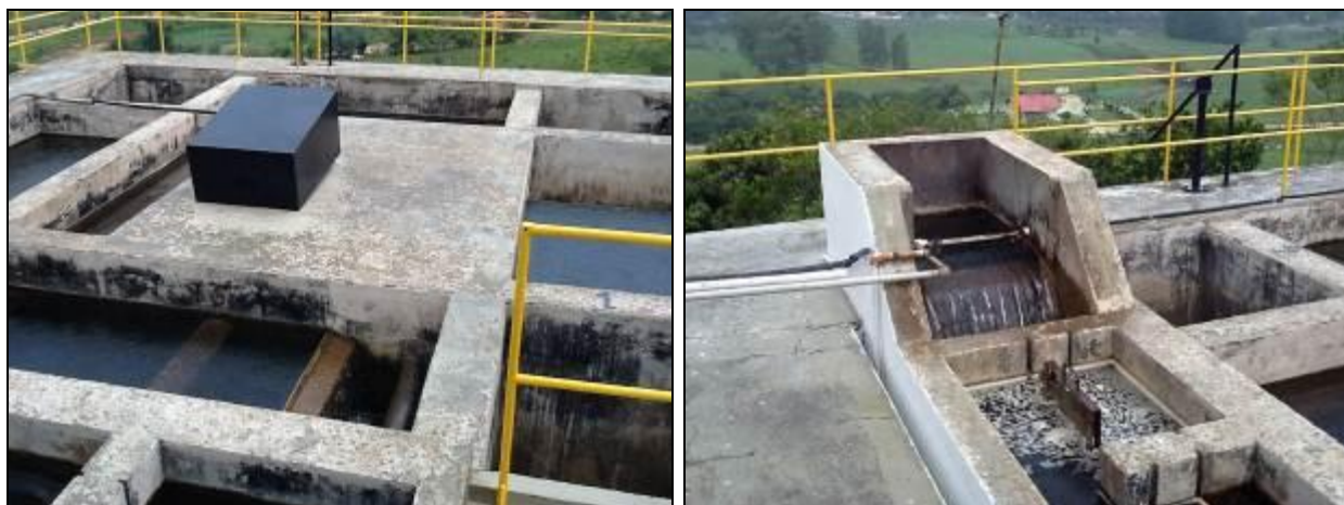
Figura 14: Floculadores e Decantadores
