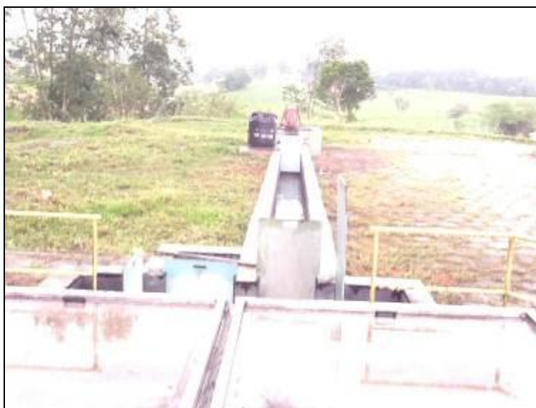
Figura 20: calhas de entrada do efluente.
