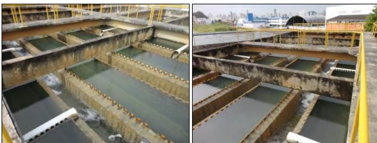
Figura 14: Decantadores da ETA (acompanhamento)
