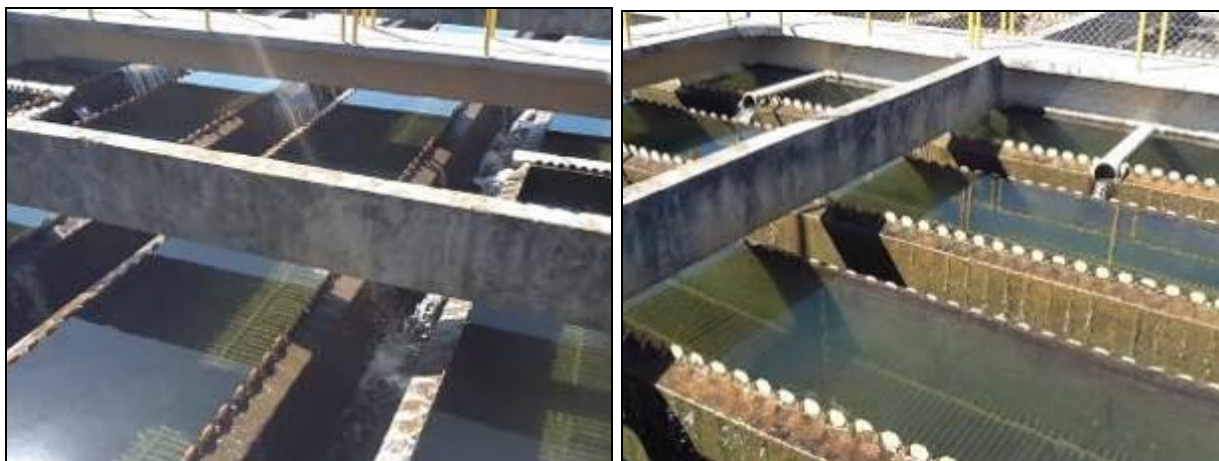
Figura 13: Decantadores da ETA (inicial)
