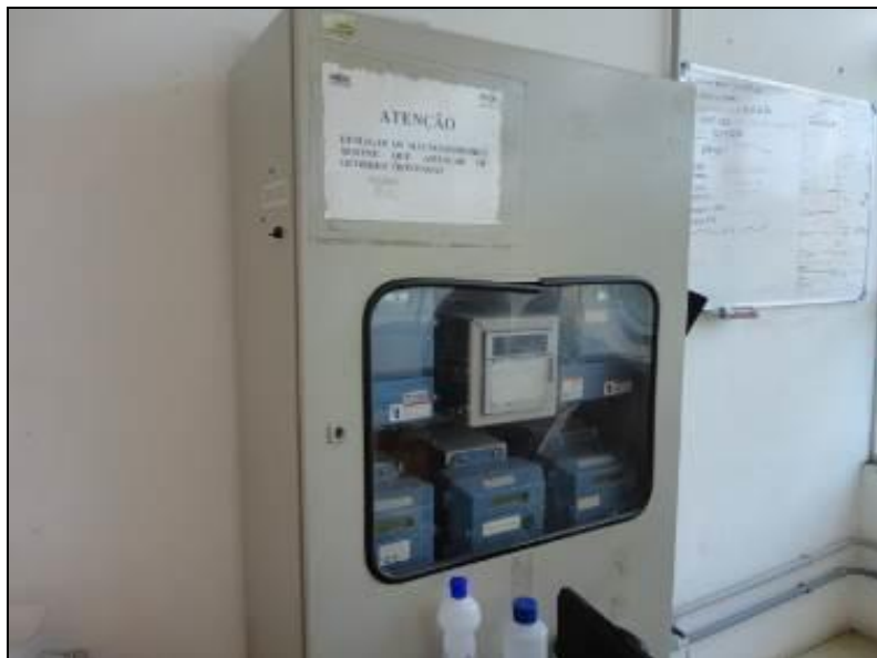
Figura 10: Macro medidores ETA
