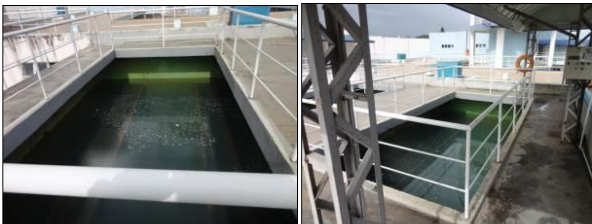
Figura 15: Filtros da ETA (acompanhamento)
