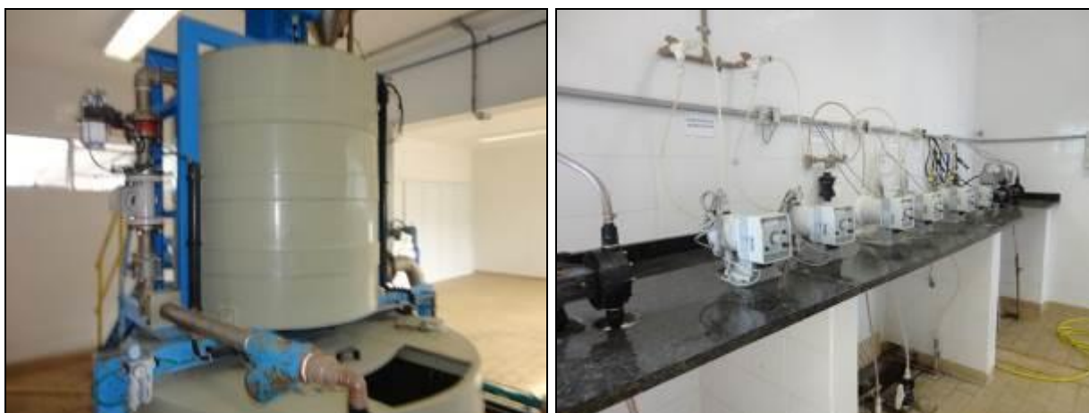
Figura 17: Casa de Química ETA (acompanhamento)
