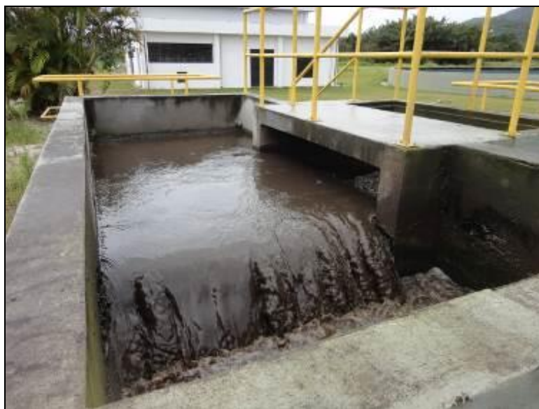
Figura 19 Entrada dos efluentes na ETE
