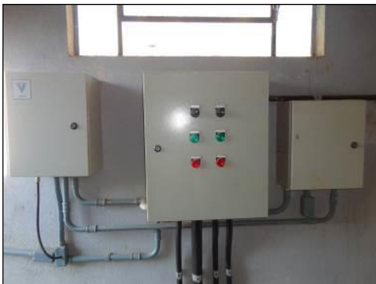
Figura 60: Quadro de Comando (acompanhamento)
