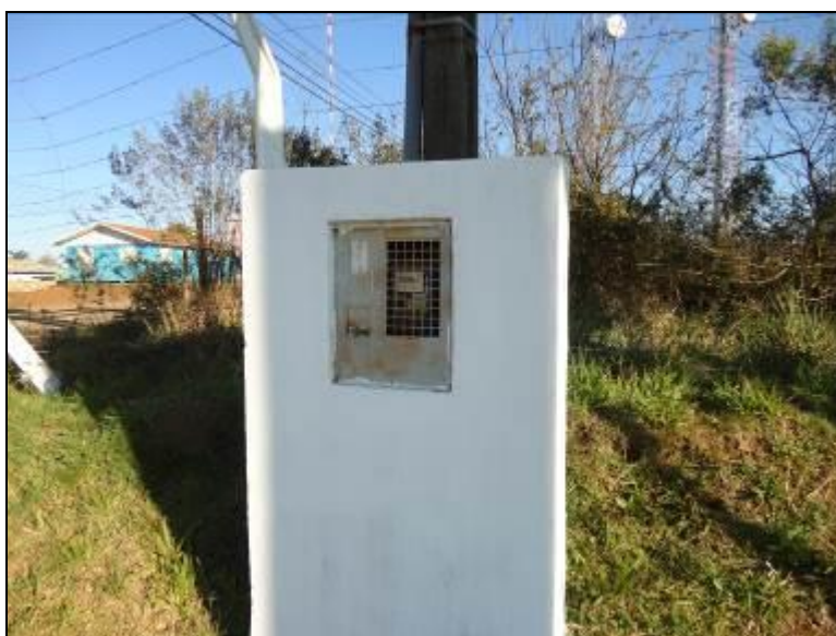
Figura 63: Quadro de Energia (acompanhamento)
