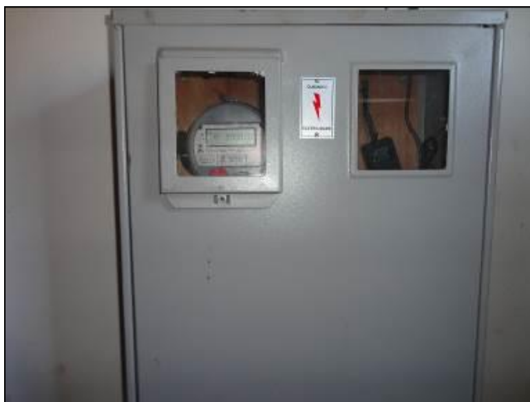
Figura 51: Quadro de energia da ERAB (acompanhamento)
