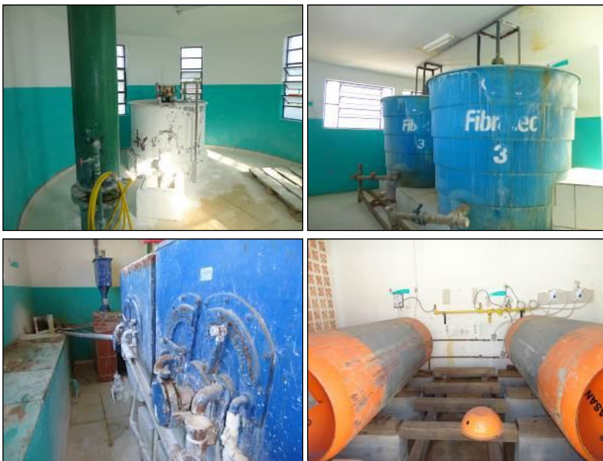
Figura 28: Casa de Química da ETA (acompanhamento)
