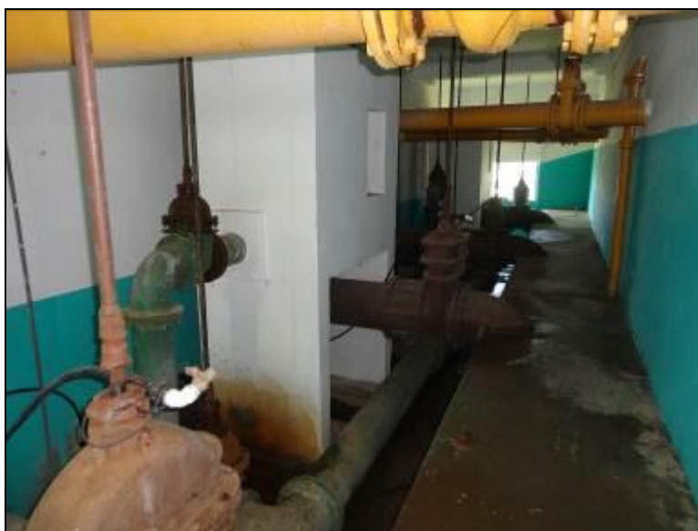
Figura 30: Engrenagens com vazamentos (acompanhamento)
