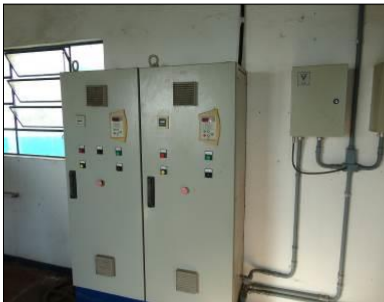
Figura 55: Quadro de comando da ERAT (acompanhamento)
