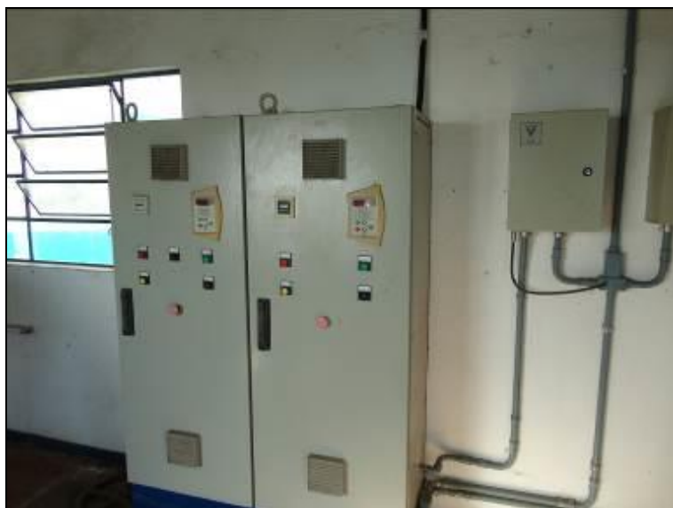
Figura 58: Quadro de comando ERAT 2 (acompanhamento)
