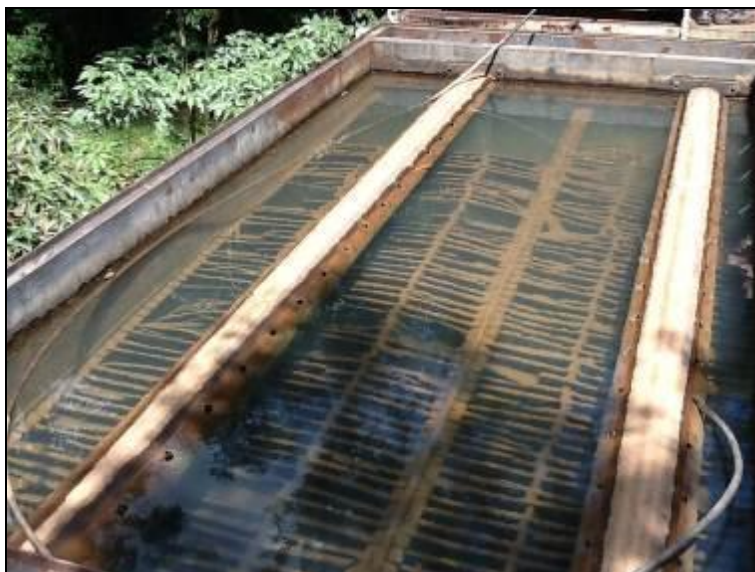
Figura 20: Decantador ETA (inicial)
