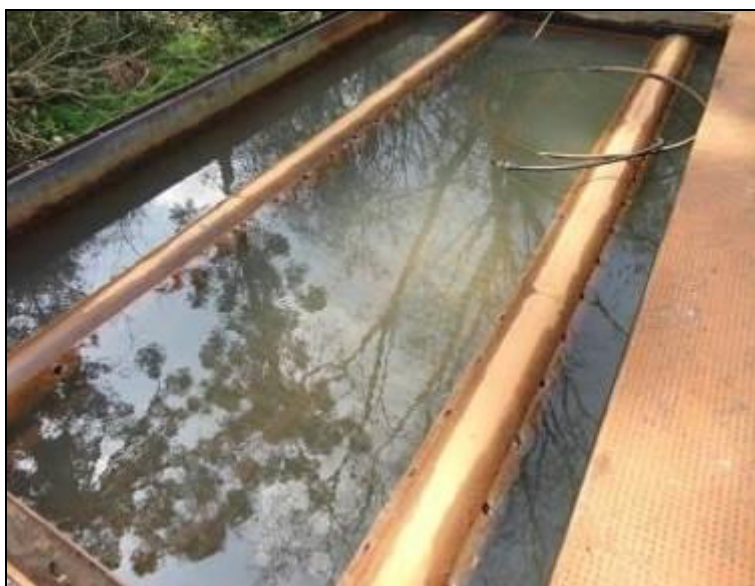
Figura 21: Decantador ETA (acompanhamento)
