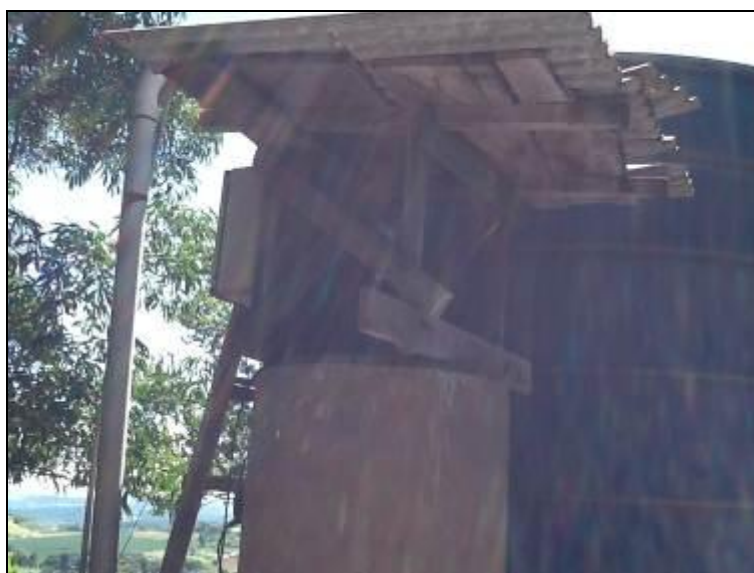
Figura 12: Estruturas provisórias e inadequadas.
