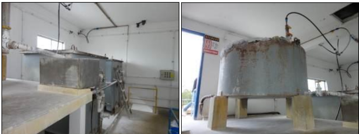
Figura 13: Estruturas de tratamento químico.
