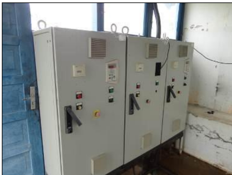
Figura 26: Quadros de Força.
