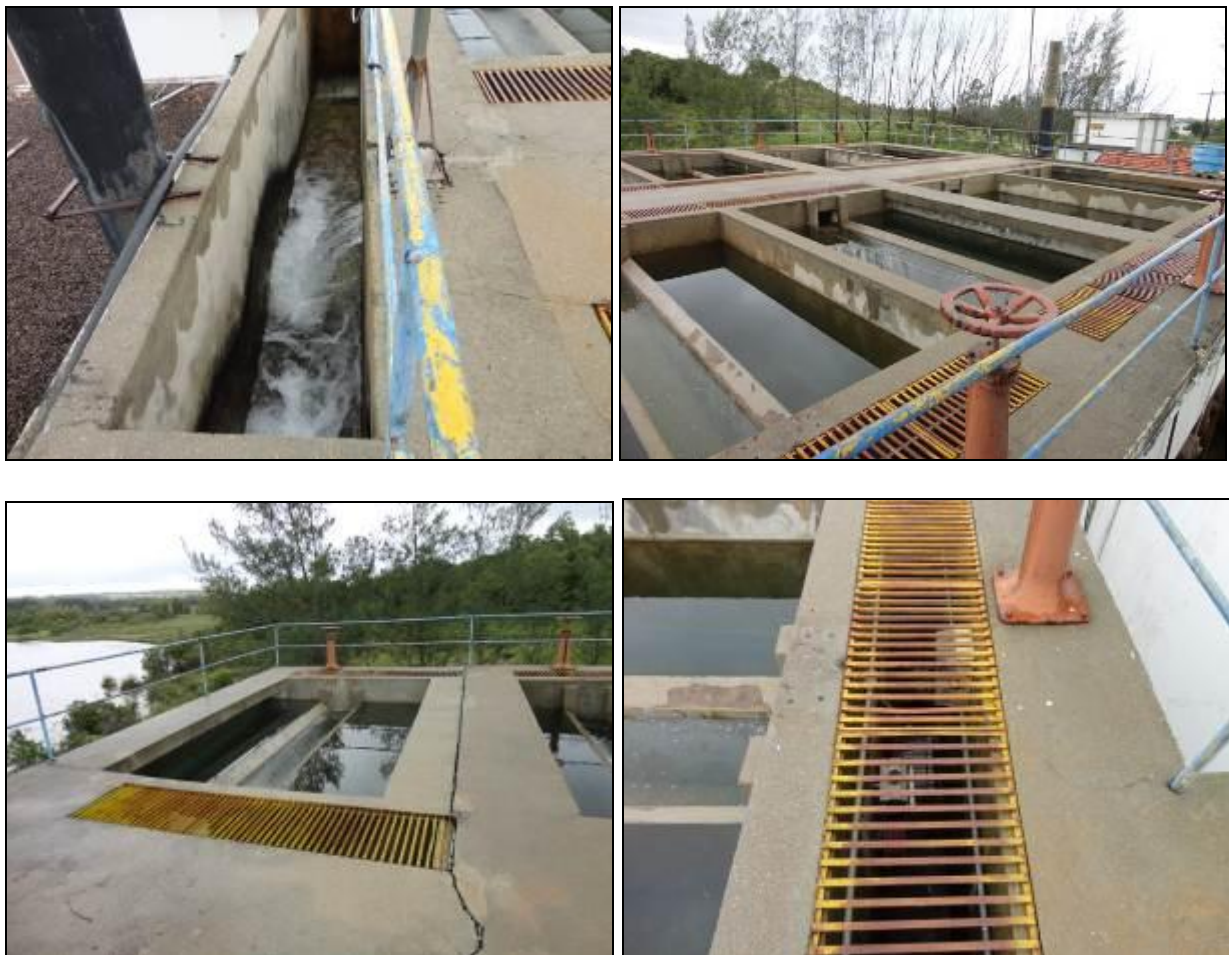
Figura 12: Estruturas para tratamento físico da água.
