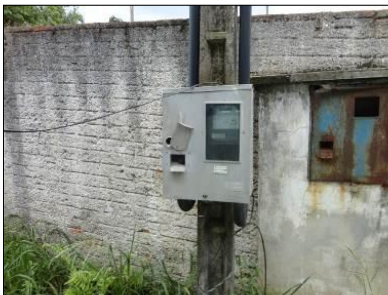
Figura 27: Medidor de energia desprotegido.
