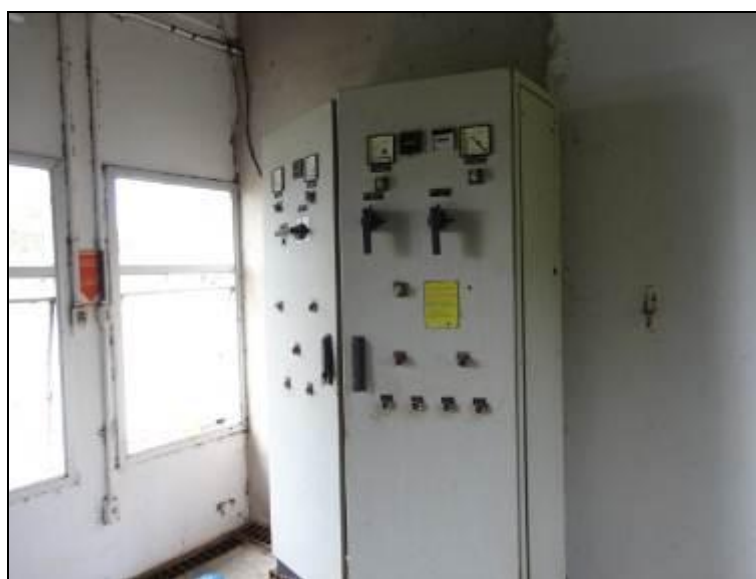
Figura 23: Quadro de força.
