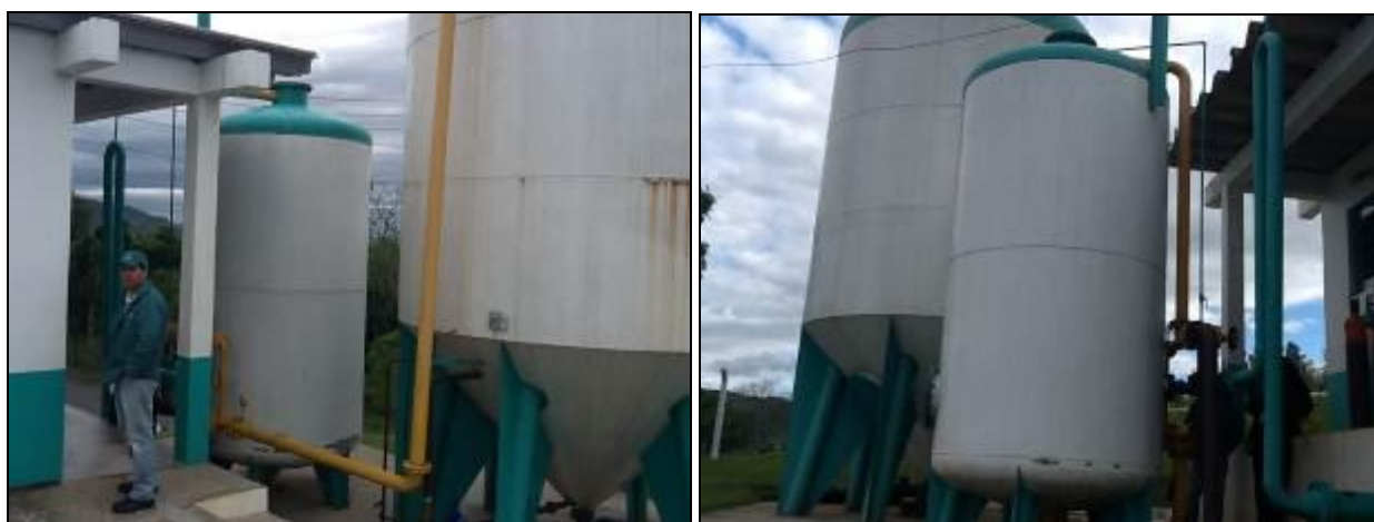
Decantador e filtro.
