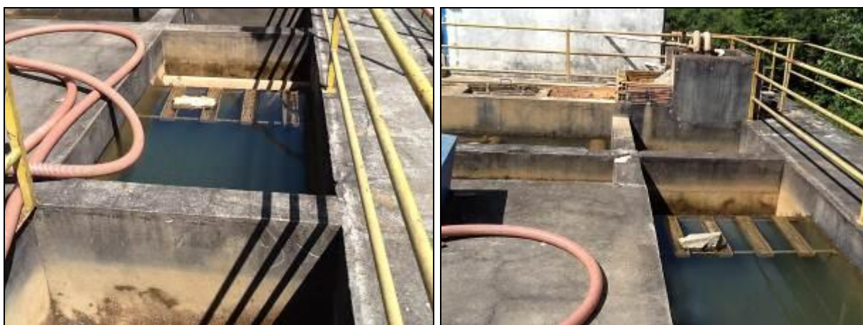
Figura 14: Estruturas necessitam de melhorias.
