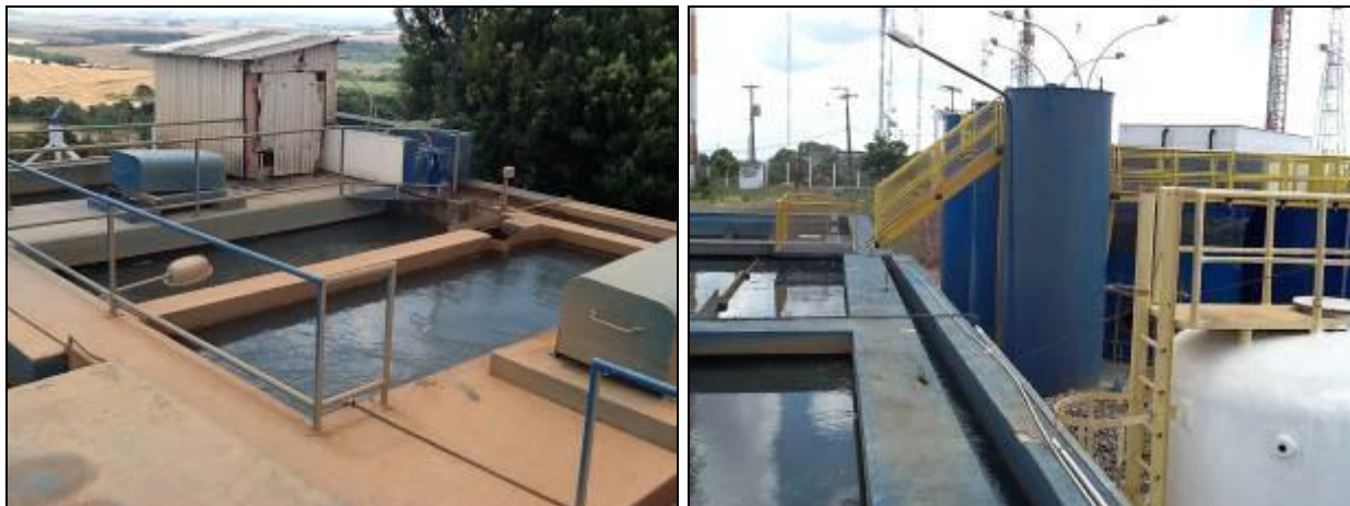
Tratamento Físico: Floculadores e Filtros
