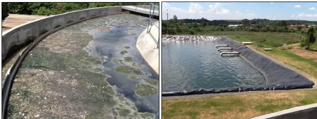
Estruturas de tratamento do SES
