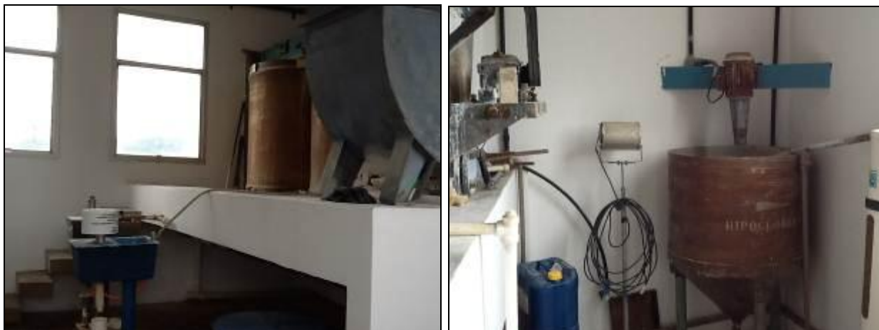
Figura 16: Equipamentos de tratamento químico.
