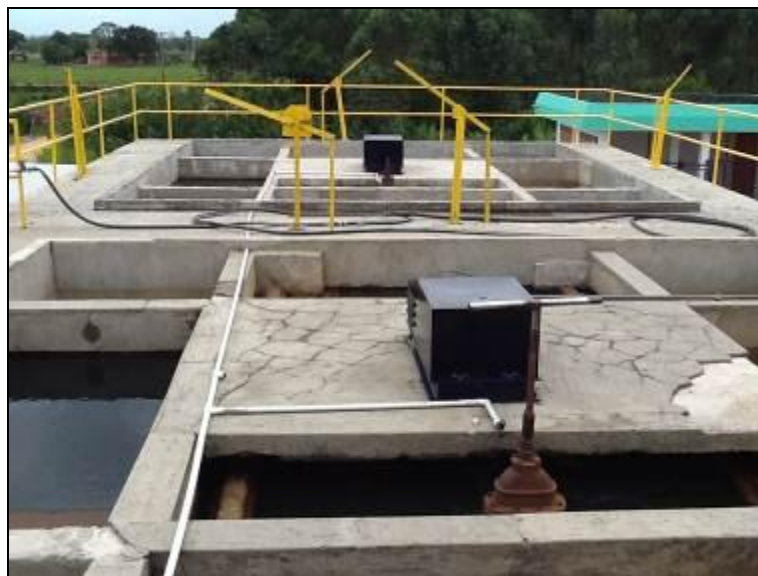
Figura 14: Guarda-corpos na ETA.
