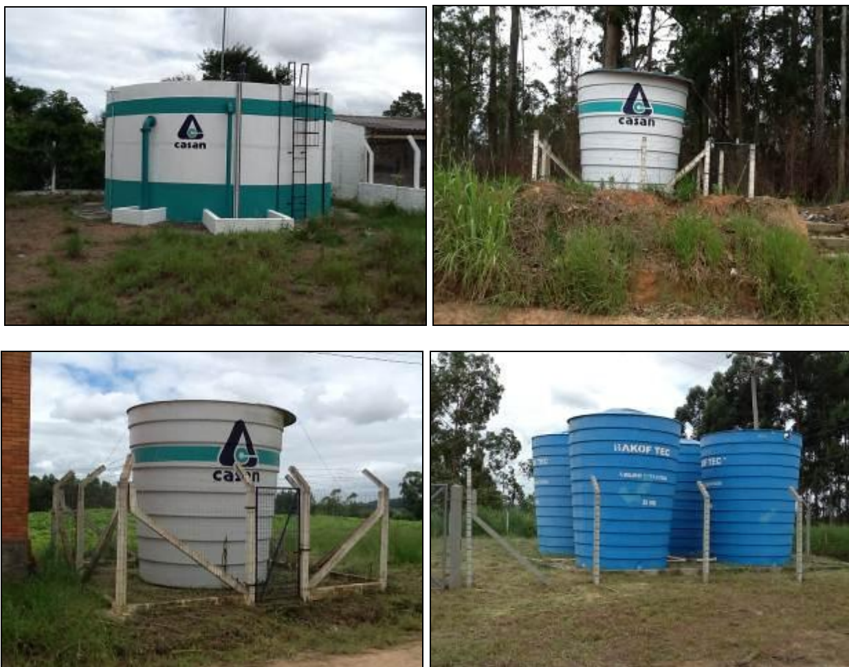
Figura 26: Outros reservatórios do Sistema.
