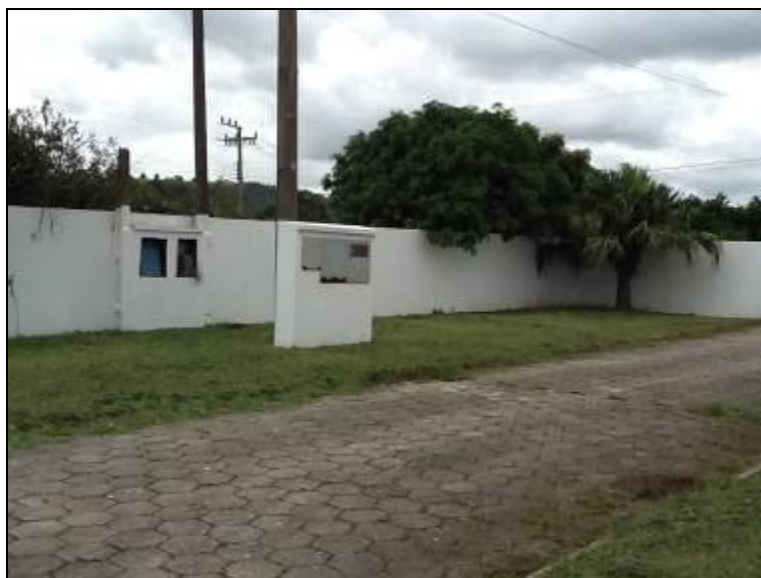
Figura 28: Quadros de força.
