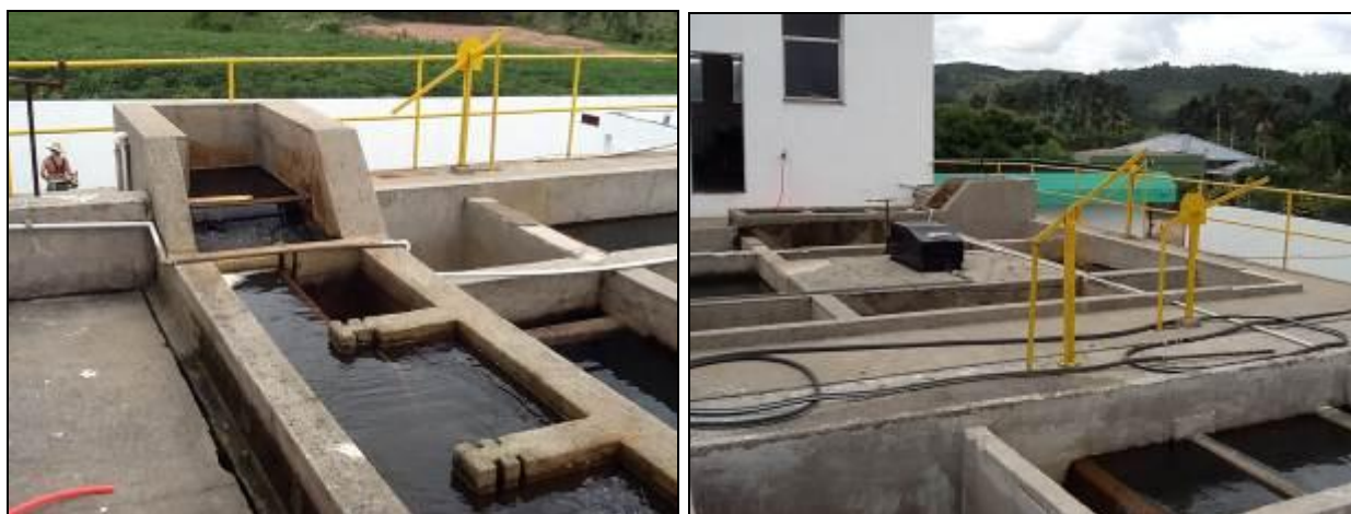
Figura 15: Floculadores, filtros e decantadores.
