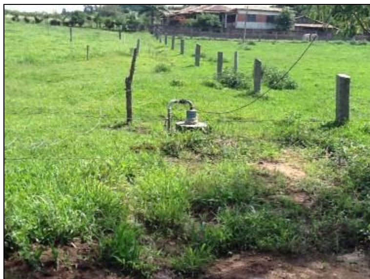
Figura 08 : Poço Loteamento Santina
