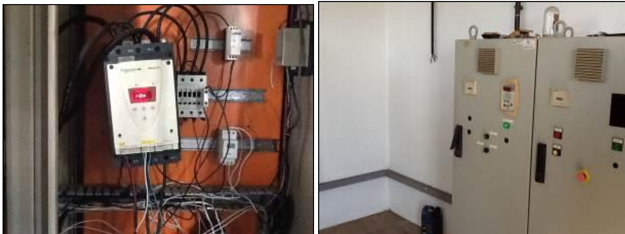
Figura 21: Quadros de Força das ERATs 01 e 02.
