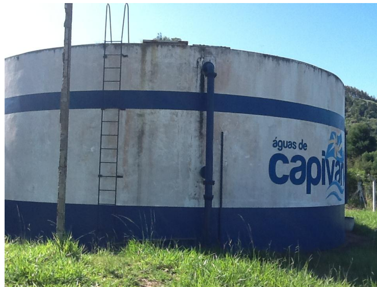
Figura 17: R-02 necessitando de pintura/lavação externa
