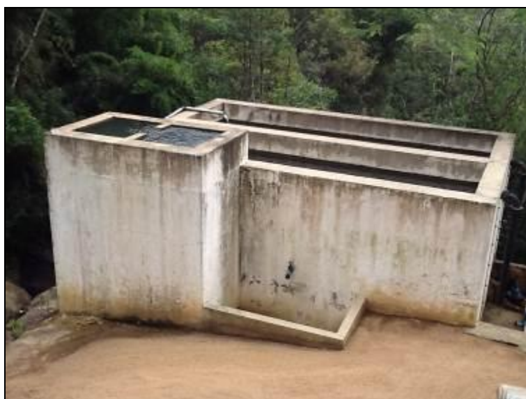
Estruturas para tratamento físico.
