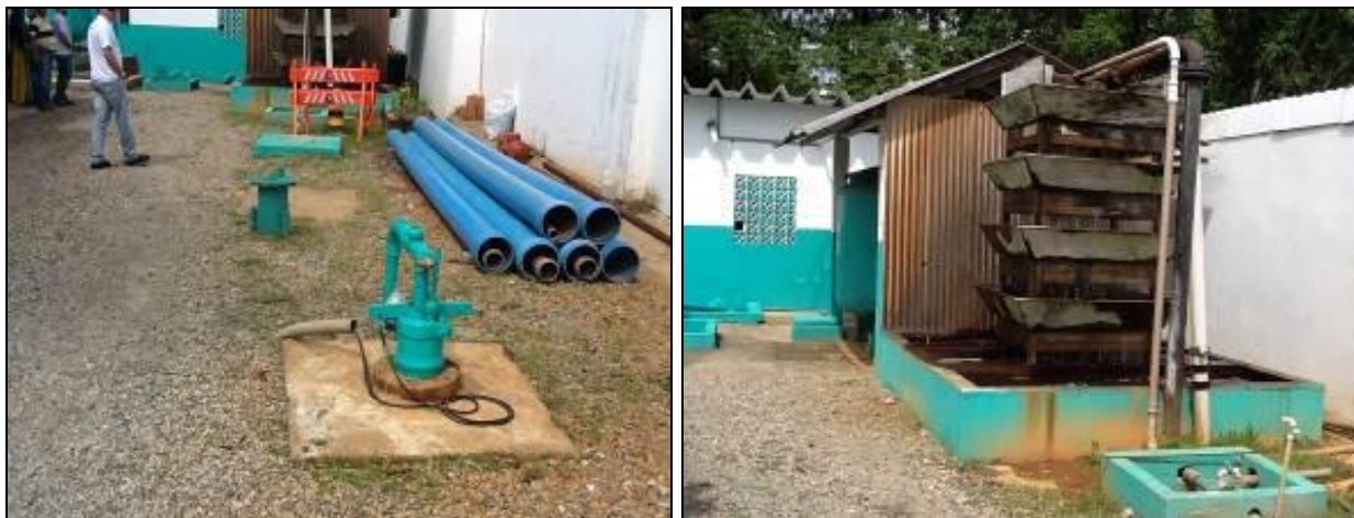
Poço 1 (esquerda) ETA Área Central (à direita)
