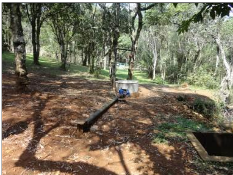
Área do manancial encontra-se cercada e identificada.
