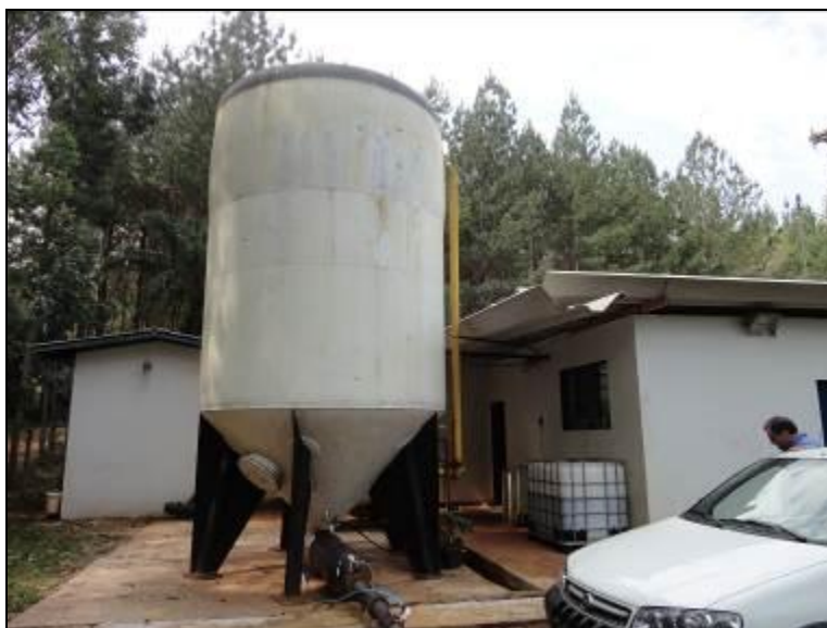
As áreas de tratamento da água físico.
