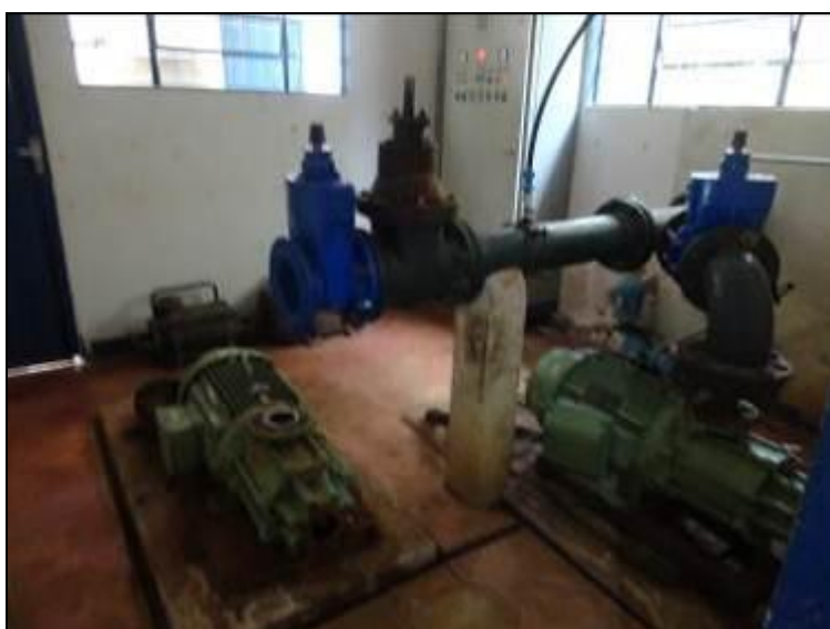
Cada das máquinas onde é feito o recalque para a ETA
