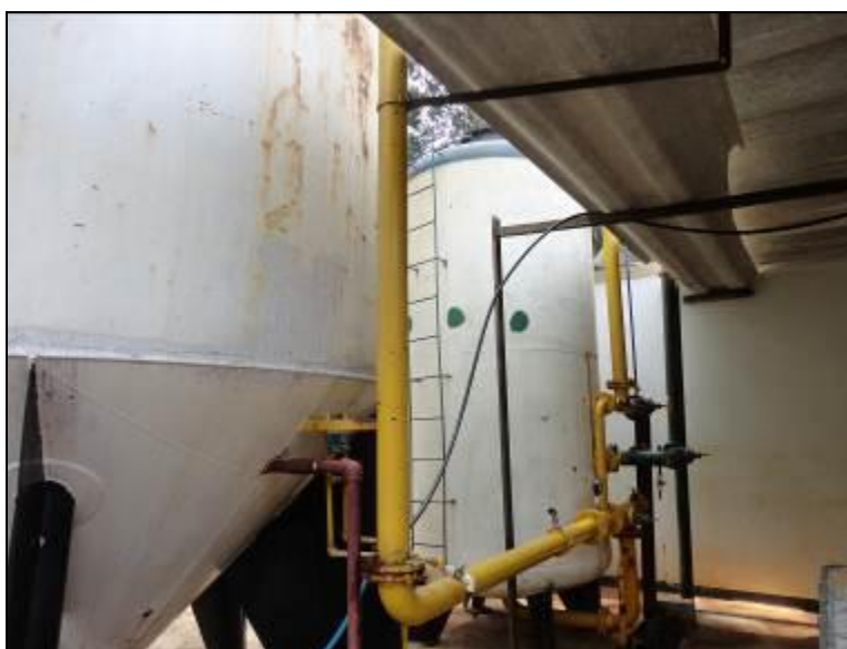
Decantador da ETA Compacta.
