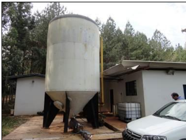
Filtro compacto da ETA.
