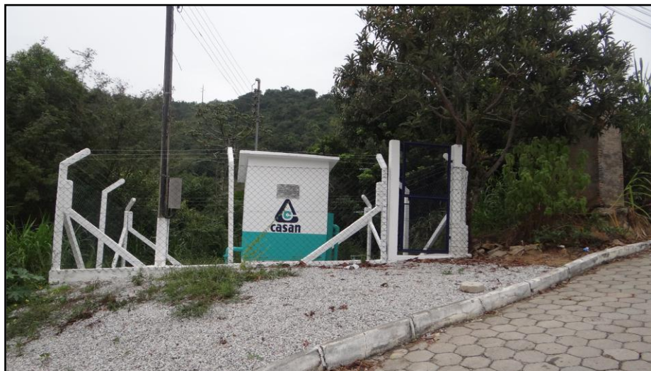
Figura 10 - BOOSTER na Rua Manoel Justino Oliveira
