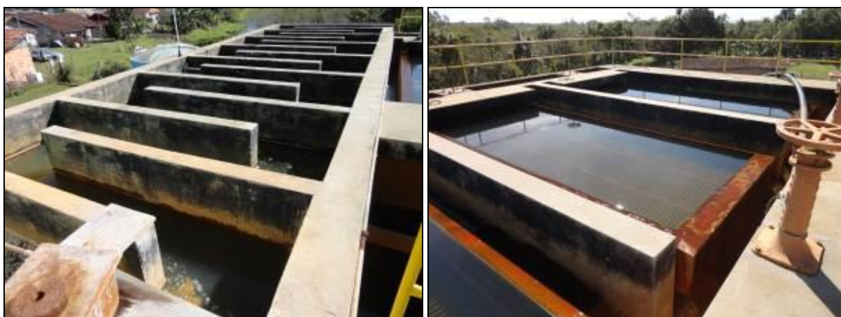
Figura 22 – Floculadores (à esquerda) e Decantadores (à direita)
