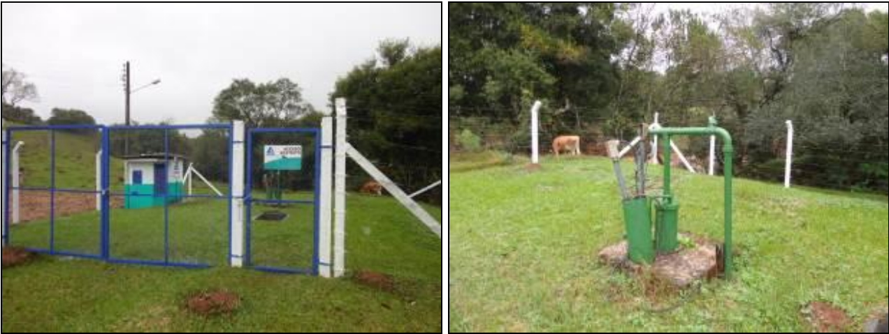
Figura 2: Captação – Poço 01 (Acompanhamento)
