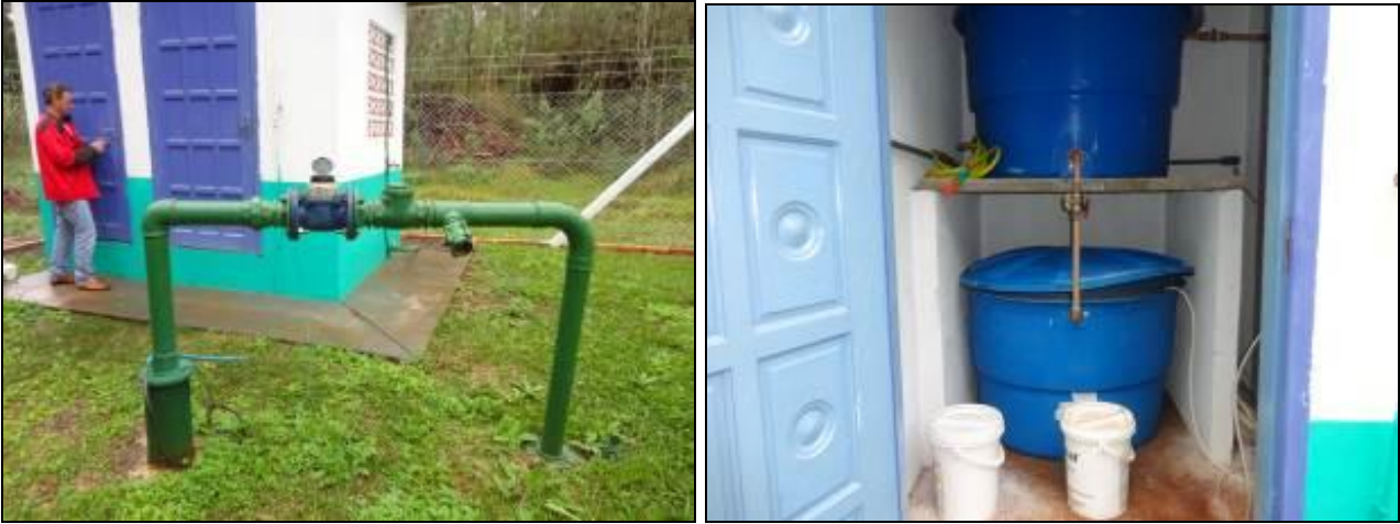
Figura 4: Captação - Poço 02- 27m 3 /h (Acompanhamento)
