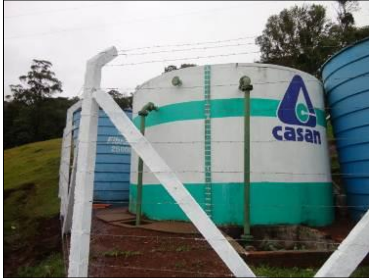
Figura 7: Área dos reservatórios cercados e trancados (acompanhamento)
