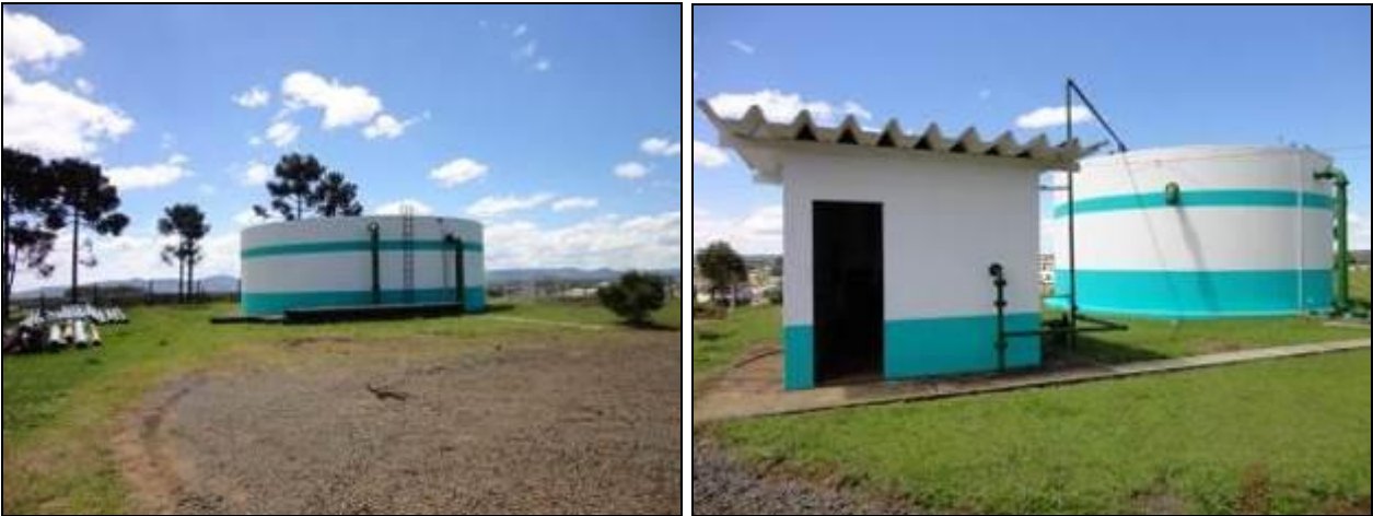
Figura 18 - Reservatórios disponível no SAA de Santa Cecília (Inicial)
