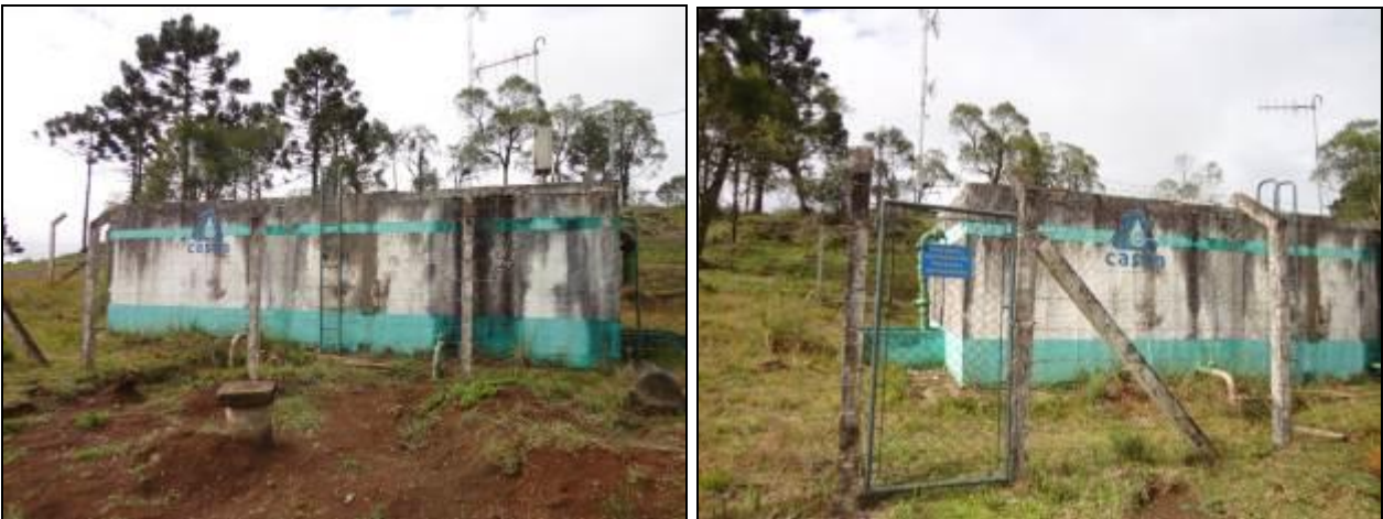
Figura 21 - Terceiro reservatório do Sistema de reservação. (Acompanhamento)
