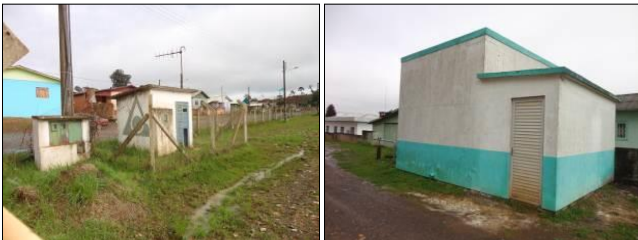
Figura 32: ERAT Marciliano (Garagem da Prefeitura) – sem pintura, sem identificação, cerca ruim – Poço 01 localizado no Shopping.
