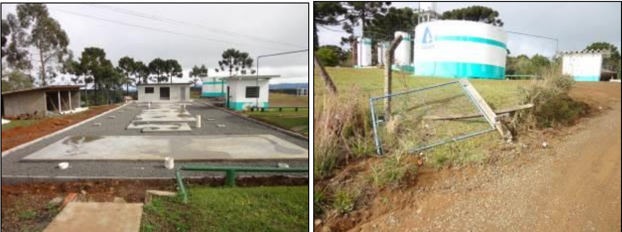
Figura 31: Outras fotos da unidade operacional, Base da nova ETA, Acesso aos reservatórios junto a ETA com portão danificado (acompanhamento)
