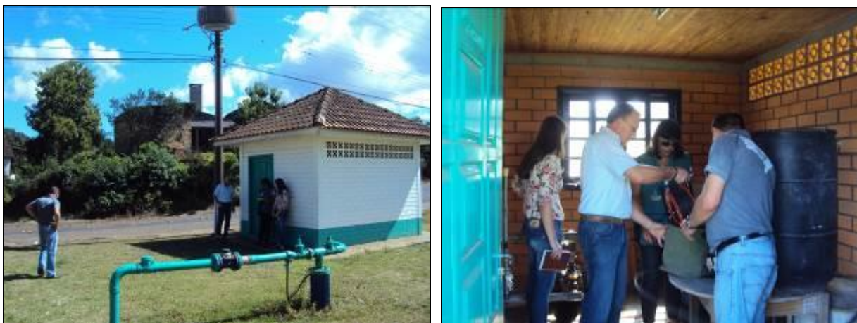
Figura 14: Segundo poço artesiano que compõe o sistema de captação municipal. (inicial)
