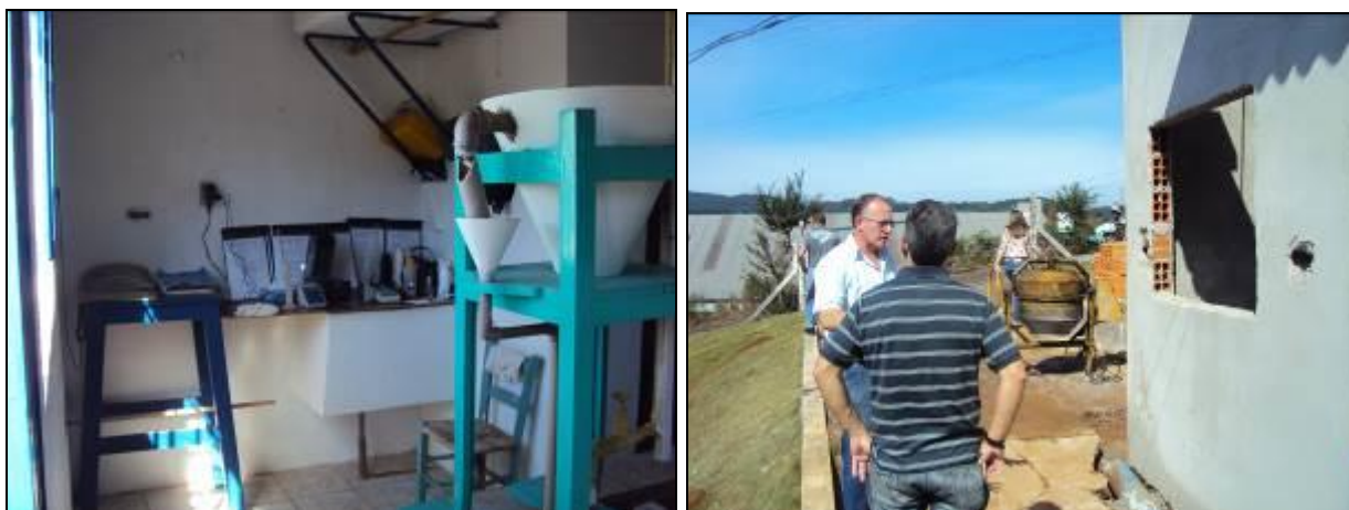
Figura 22: Condições apresentadas no Laboratório antigo e construção do novo à direita (inicial)
