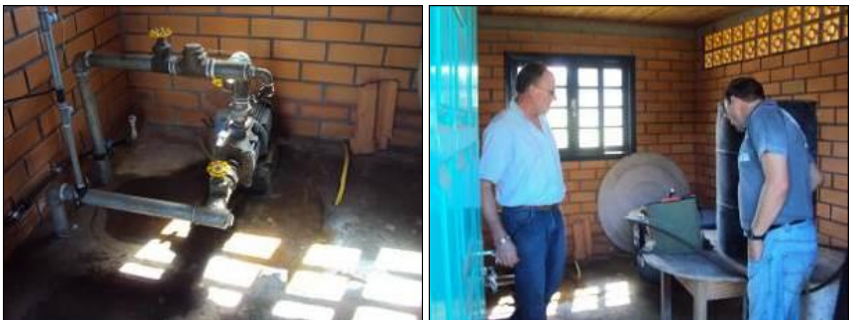
Figura 30: Área interna do bombeamento dos poços (inicial)
