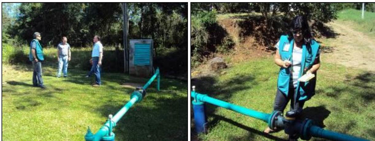
Figura 12: Visão geral da Captação através de poço artesiano, situada nas proximidades do centro. (inicial)
