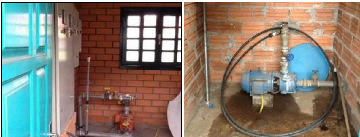
Figura 311: Área interna do bombeamento dos poços (acompanhamento)
