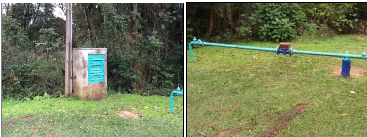
Figura 13: Poços continuam sem as cercas de proteção (acompanhamento)
