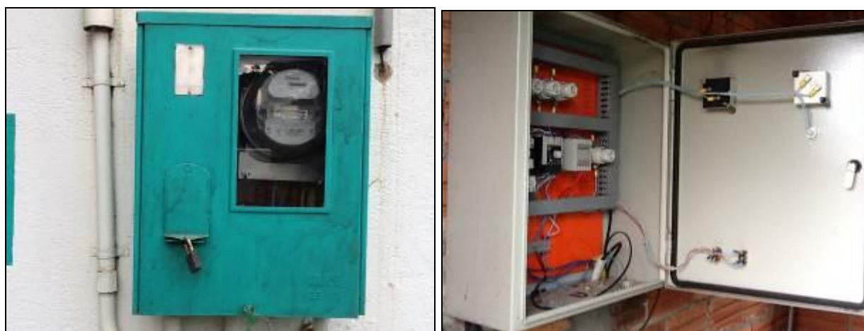
Figura 32: Relógio e quadro de energia (Acompanhamento)
