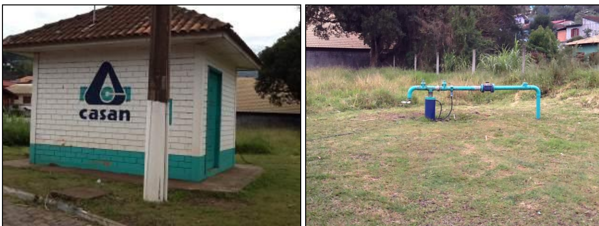
Figura 15: Segundo poço artesiano que compõe o sistema de captação municipal (acompanhamento)
