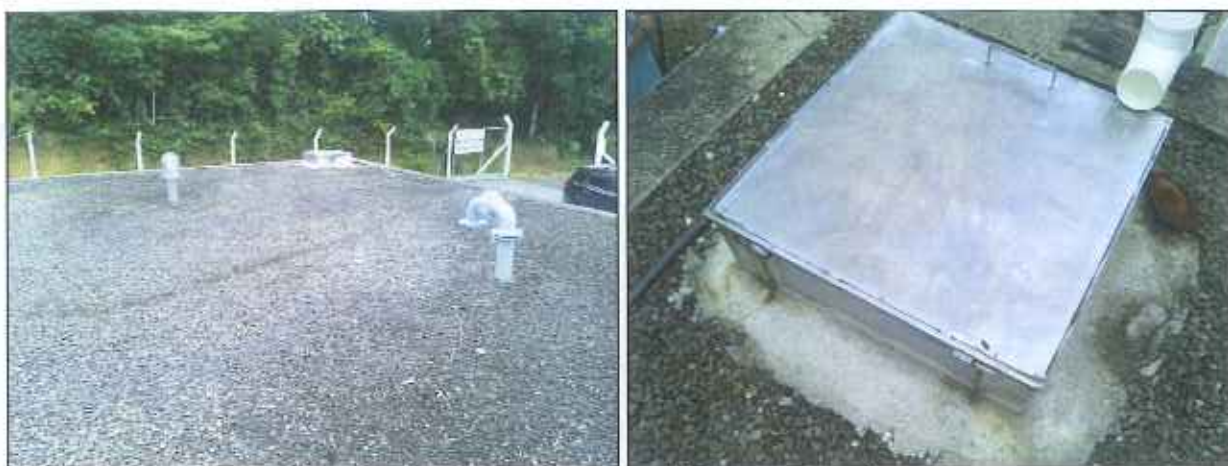
Figura 5: Cobertura do reservatório sem guarda-corpo
