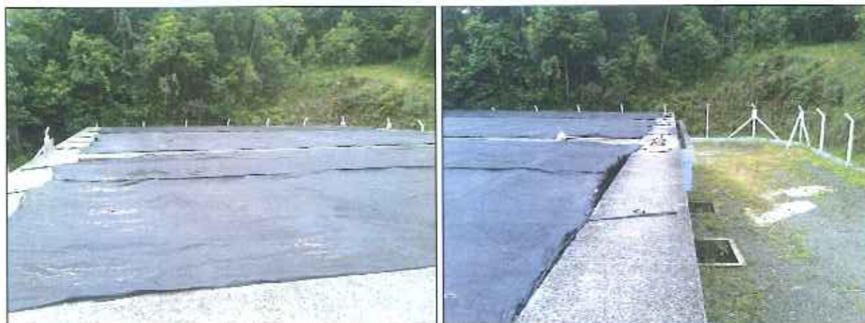
Figura 2: Filtros da ETA sem guarda-corpo
