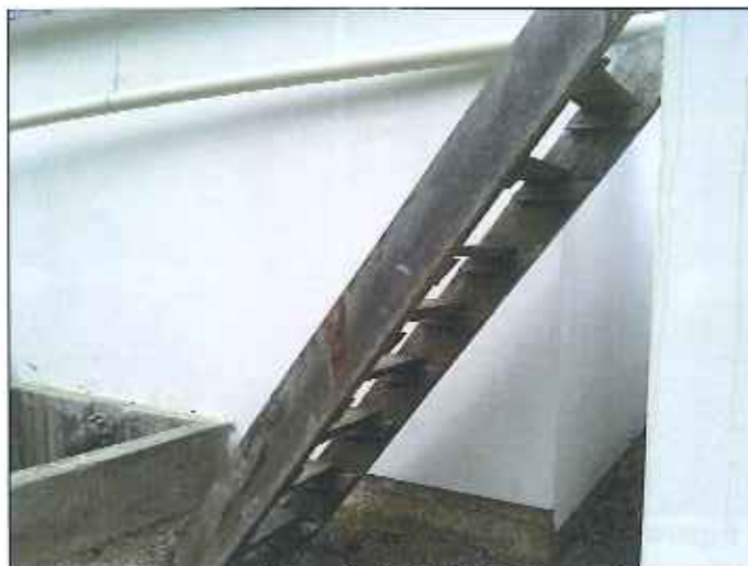
Figura 9: Escada da ETA inadequada
