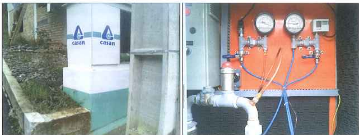
Figura 12: Booster Vista do Sol
