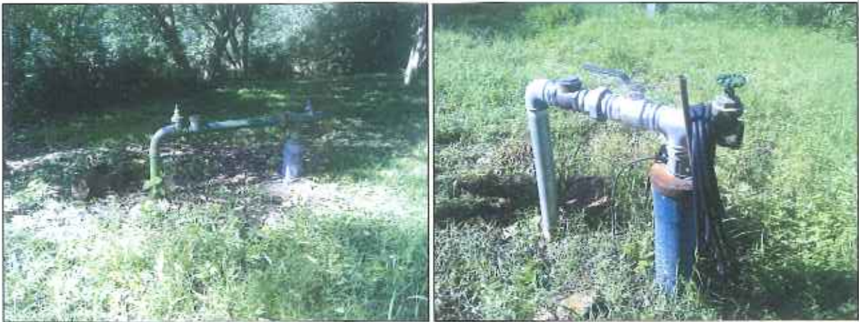
Figura 4: Poço I à esquerda e Poço II à direita
