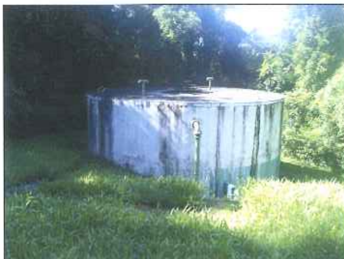
Figura 8: Reservatório da ETA
