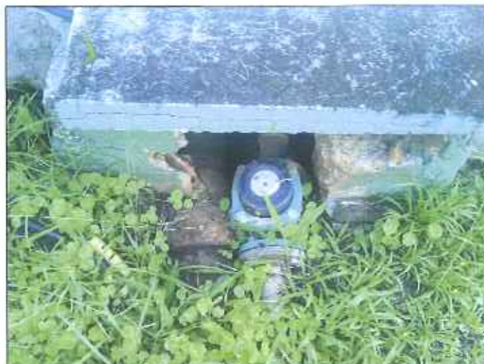
Figura 5: Macromedidor de entrada da ETA
