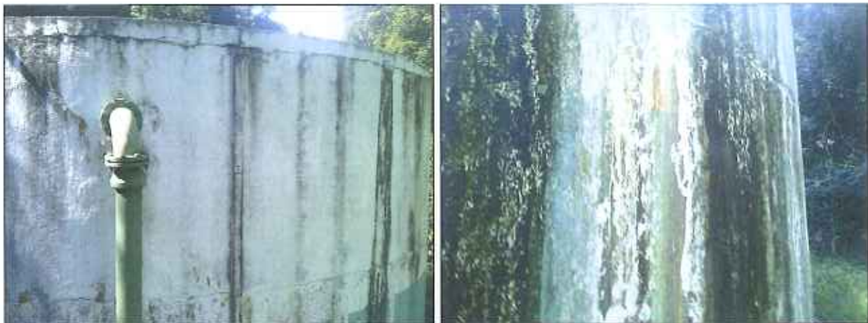
Figura 7: Reservatório da ETA com muita infiltração
