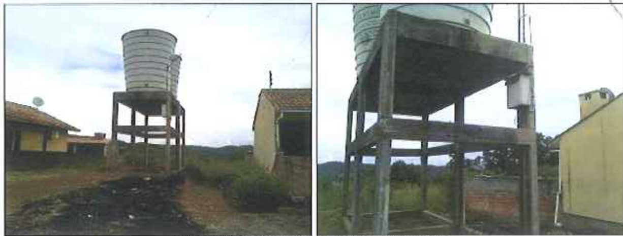
Figura 10: Reservatório R01.3 – 20 m³ cada
