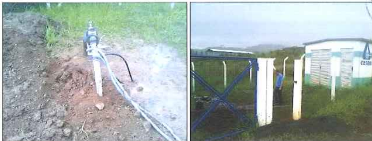
Figura 5: Poço Loteamento Industrial/Campina Bela e casa de química
