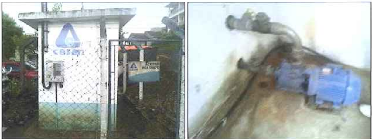
Figura 45: ERAT 3.2, com vazamento
