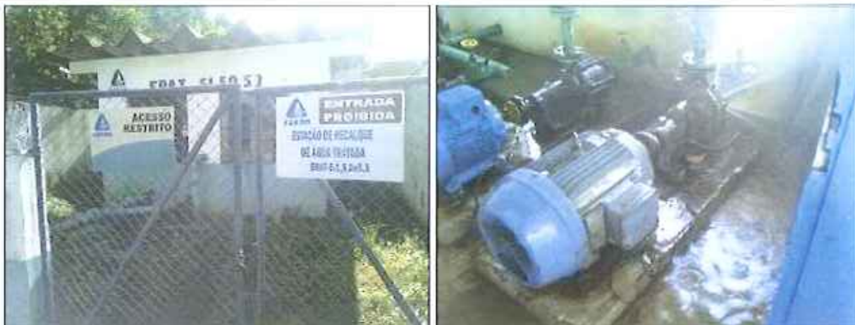
Figura 49: ERAT 5.1 / 5.2 / 5.3, com vazamento
