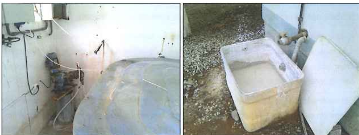
Figura 58: Vista interna das condições de tratamento da casa de química do poço Rio das Pedras I
