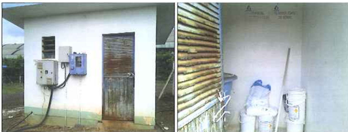
Figura 57: Casa de química do poço Rio das Pedras I, vista externa e interna
