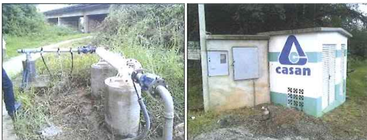
Figura 4: Poço Rio das Pedras II e casa de química
