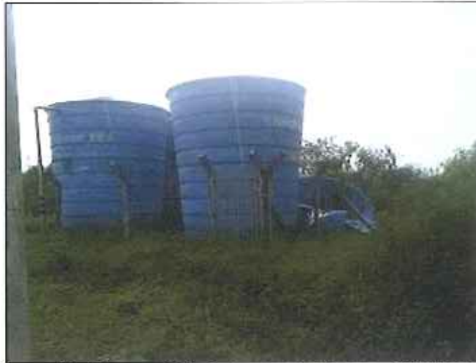
Figura 31: Reservatório Loteamento Flores – 20 m 3 cada
