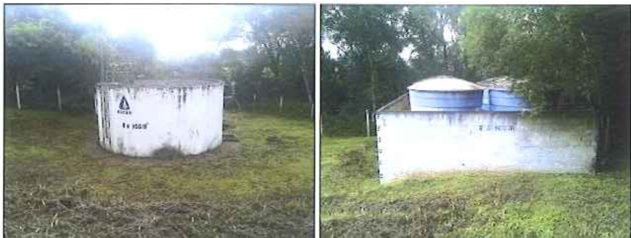
Figura 30: Reservatórios R06 – 100 m 3 + 25 m 3 cada
