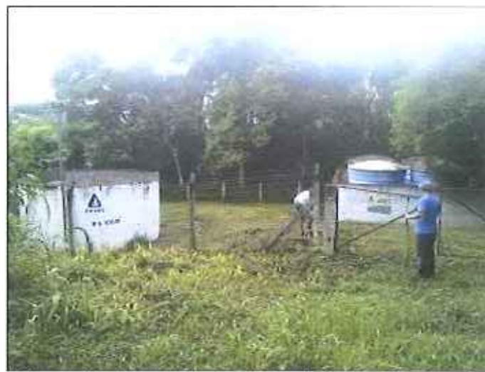
Figura 29: Reservatórios R06 – 100 m 3 + 25 m 3 cada
