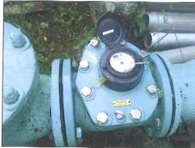
Figura 10: Macromedidor de água bruta
