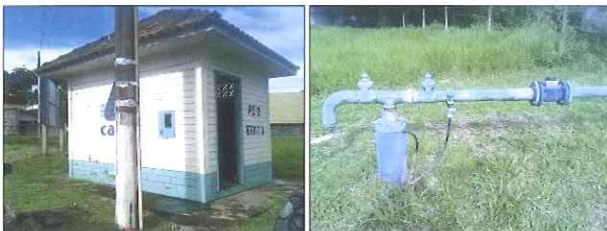
Figura 7: Poço II sem isolamento
