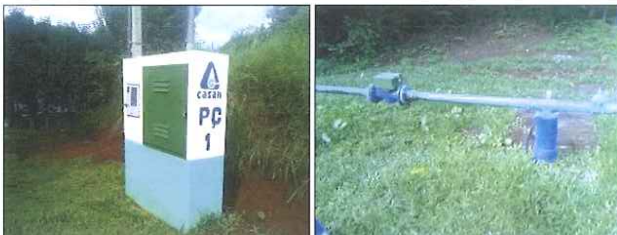
Figura 6: Poço I sem isolamento
