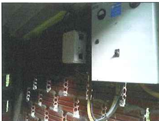
Figura 14: Disjuntor da ERAT
