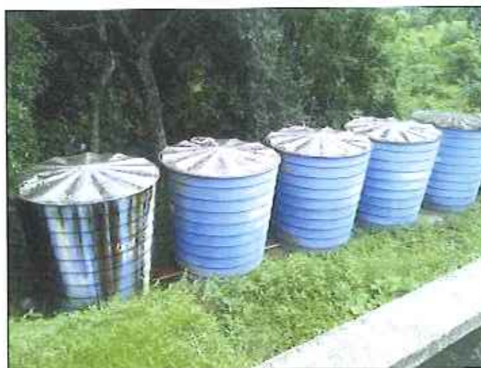
Figura 9: Reservatórios junto a ETA
