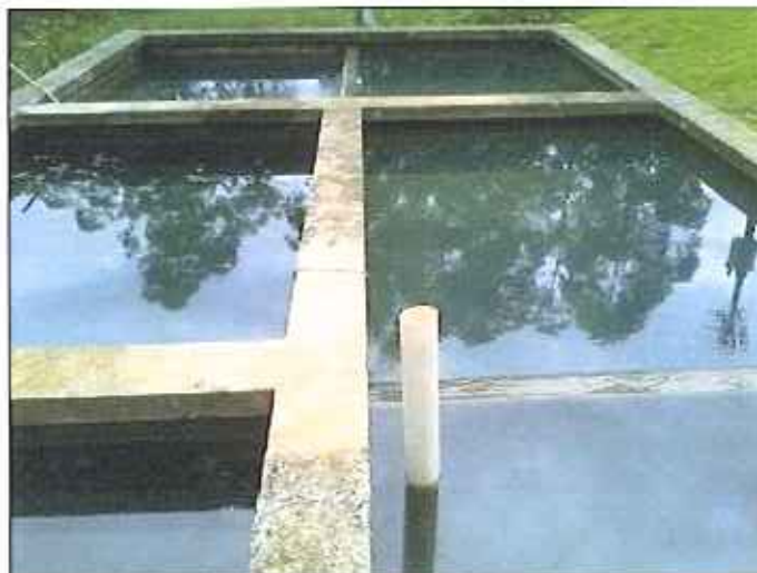
Figura 5: Decantadores da ETA
