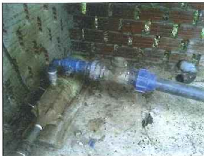
Figura 13: ERAT junto a ETA
