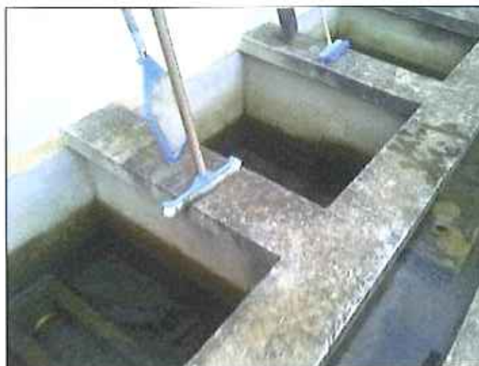
Figura 6: Filtro da ETA
