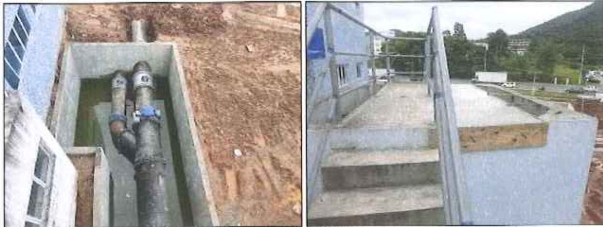
Figura 2: Macromedidores instalados na adutora de 800 mm (à esquerda) e nova caixa de passagem para dosagem de produtos químicos (à direita)
