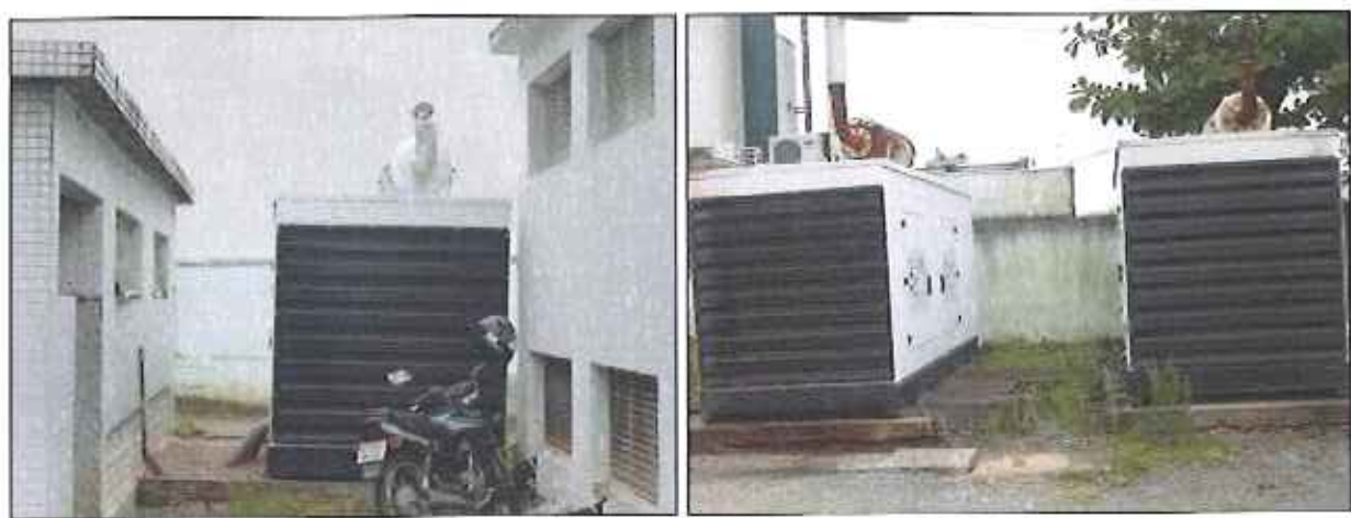
Figura 4: Grupos geradores de energia elétrica da ETA
