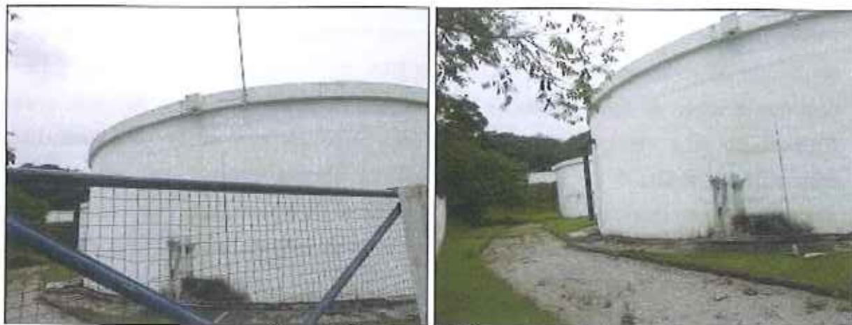
Figura 7: Reservatório 3 em operação
